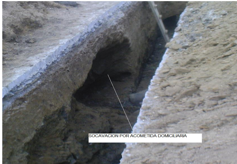
Figura 24. Socavación por acometida domiciliaria
