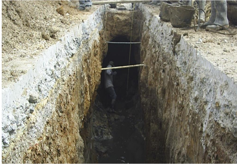
Figura 19. La altura desde la cota batea hasta la capa de base del pavimento sobrepasa los 2 metros.
