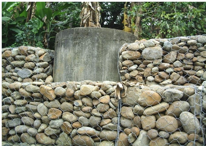
Figura 18. Cámara de inspección protegida
