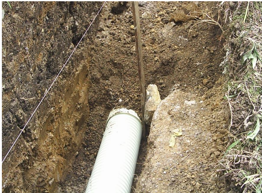
Figura 4. Se pudo revisar el perfecto empalme de tuberías
