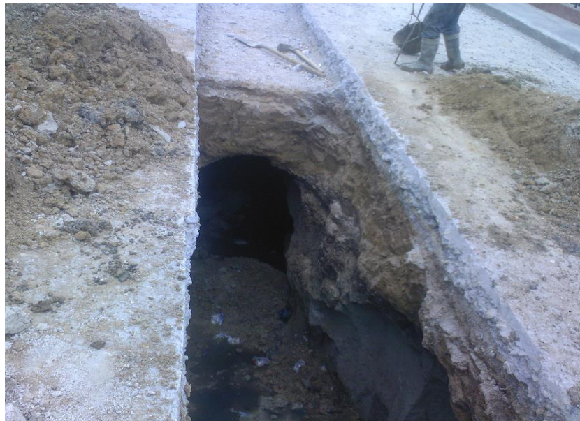
Figura 20. Socavación debido a la destrucción de la tubería
