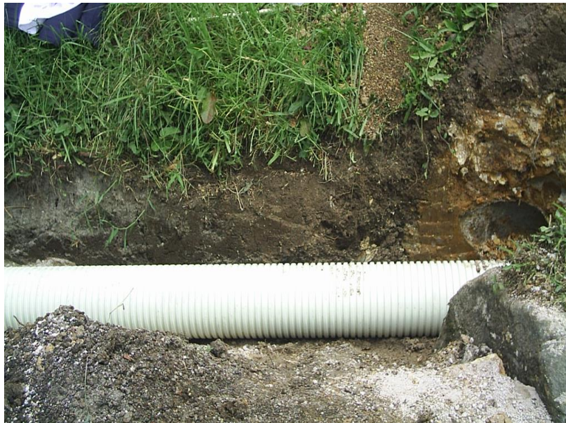
Figura 7. Esta imagen muestra lo cercana que estaba la tubería a la razante
