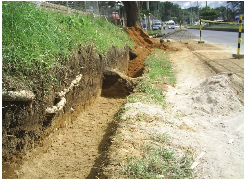
Figura 6. Material de relleno tipo I, tipo II y material que sirvió de capa de asiento en la obra
