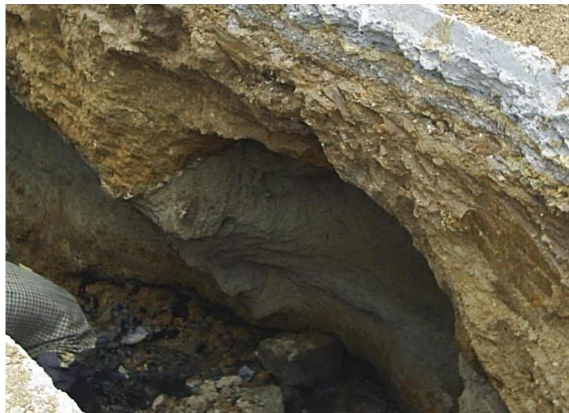
Figura 25. Inestabilidad del a excavación
