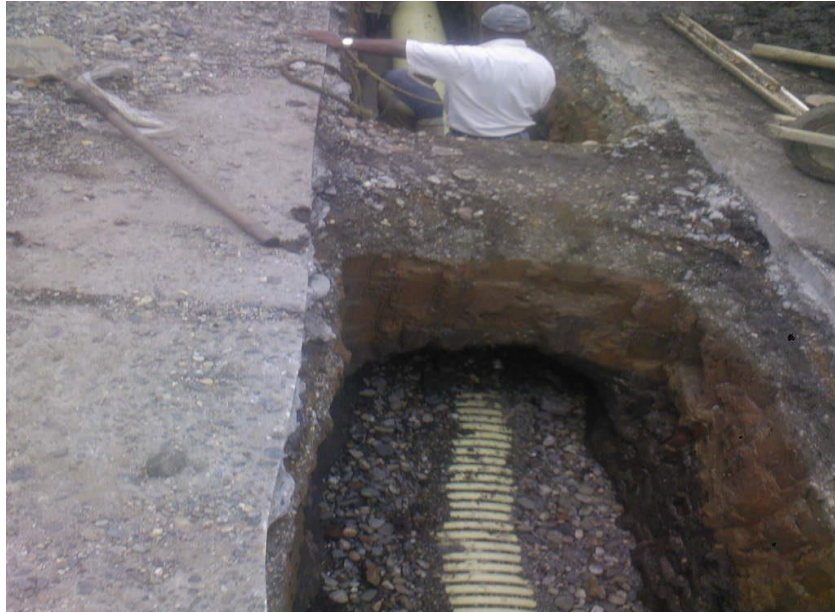
Figura 42. Ensamble de tuberías
