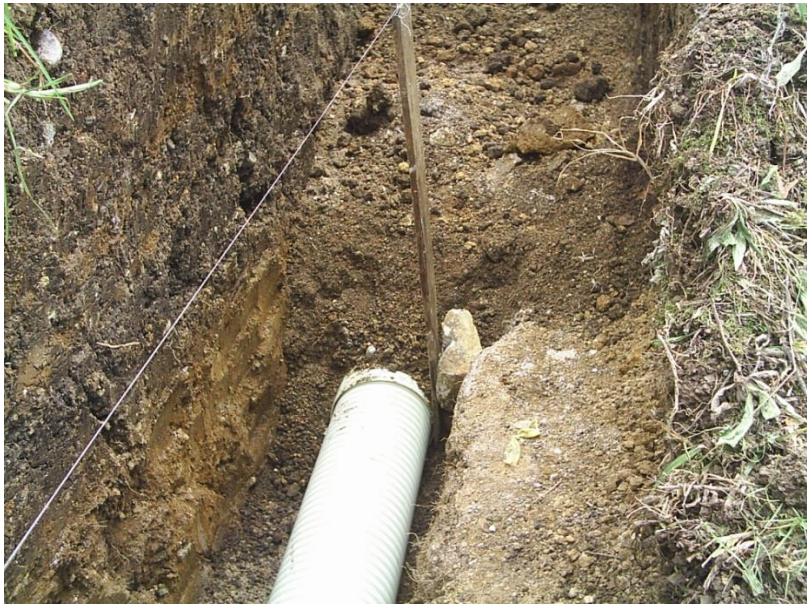
Figura 1. Chequeo de pendiente mínima por medio de niveles para la eficiente evacuación de aguas
