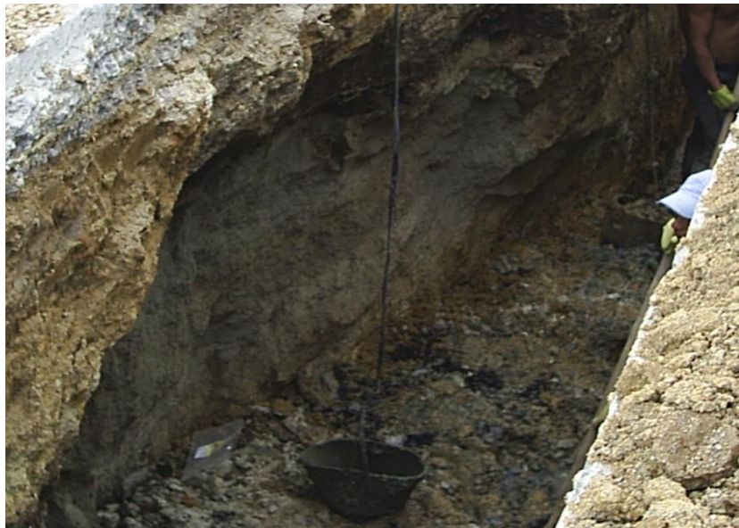
Figura 22. Tubería destruida en la red
