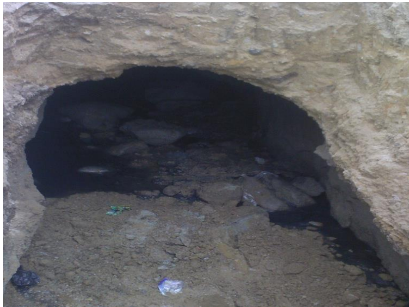
Figura 21. Túnel creado por el agua debido a socavación
