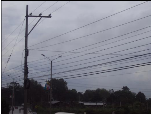
Foto No. 5 – Redes de Energía (Media y Baja Tensión) Costado oriental.
