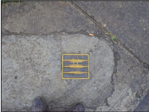
Foto No. 11 – Red de Gas. Alcanos S.A.
