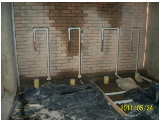
Instalaciones hidráulicas en tierra (orinales)
