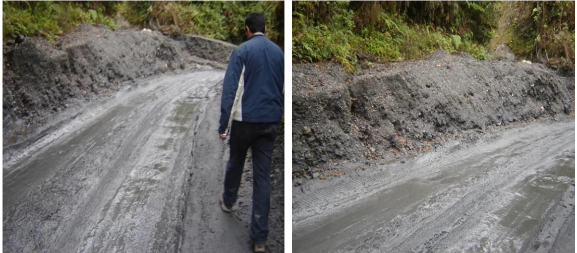
ESTADO INICIAL DE LA VÍA EN EL SITIO CRITICO
