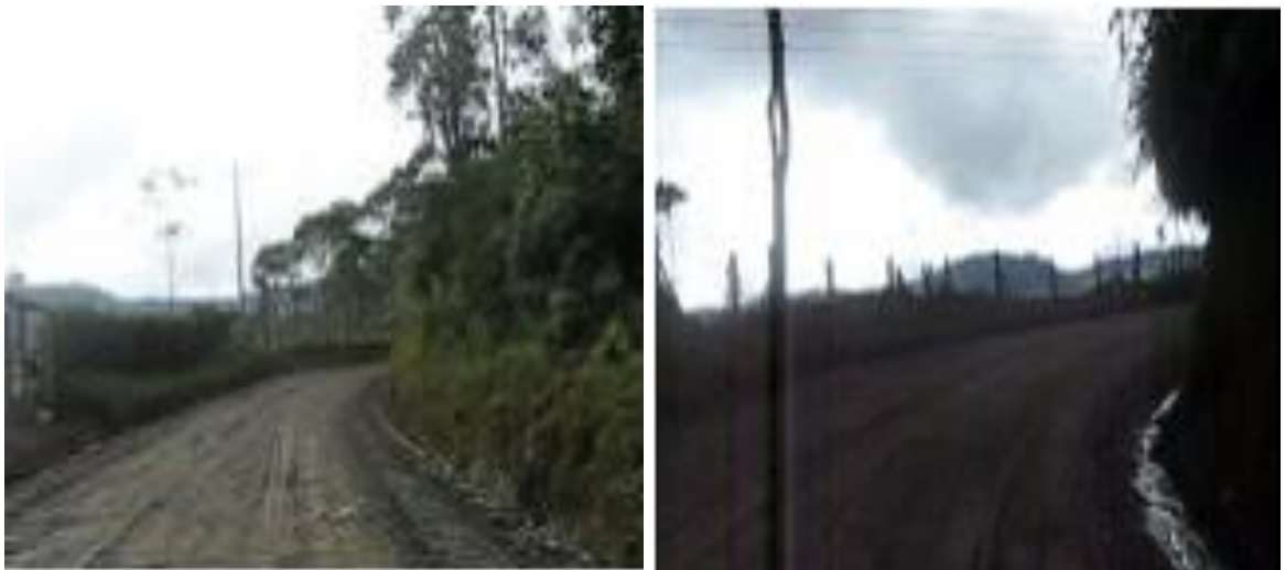
ESTADO DE INICIAL DE LA VÍA
