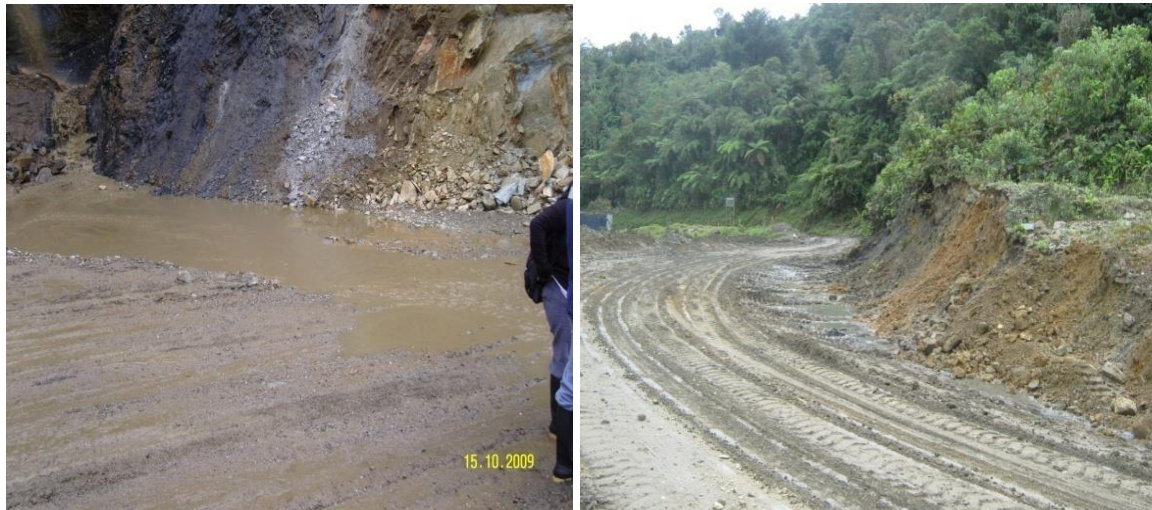
SE PUEDE OBSERVAR EL ESTADO DE LA VÍA DESPUÉS DE LA REMOCIÓN
