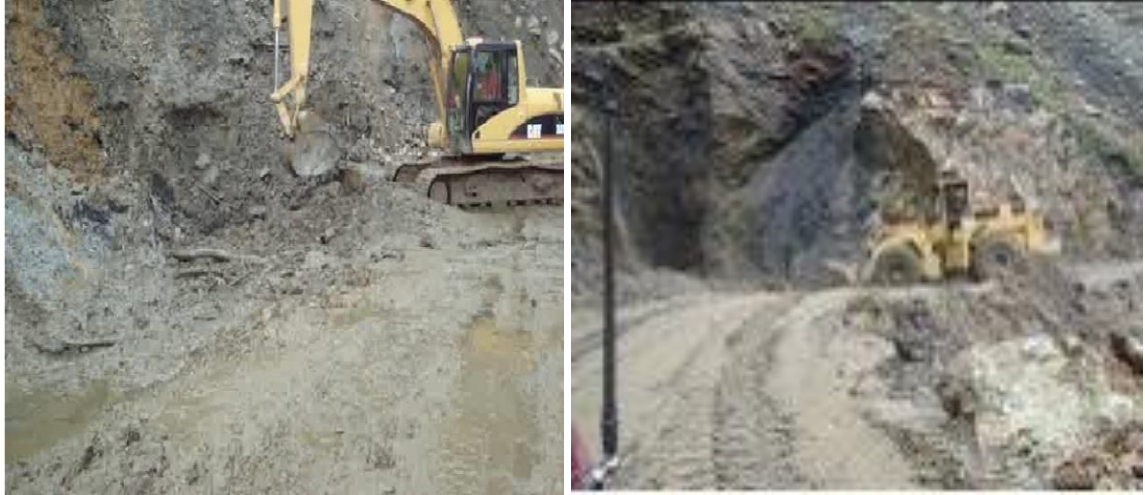
SE PUEDE OBSERVAR LA REMOCIÓN DE LOS DERRUMBES EN EL SECTOR
