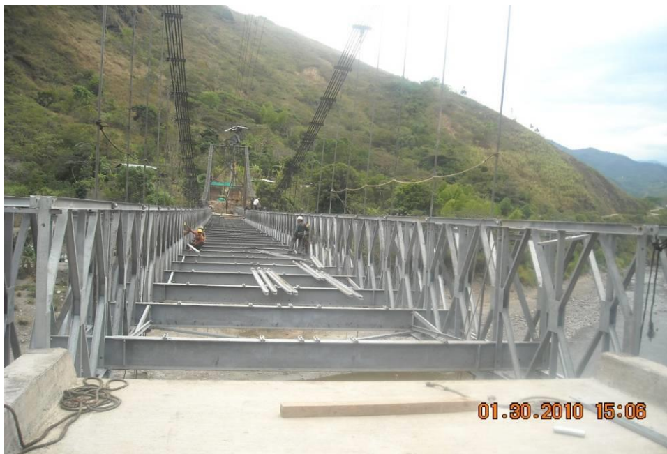
VISTA DE LA ESTRUCTURA METÁLICA – PUENTE SOBRE EL RIO NEGRO. SECTOR JUNTAS
