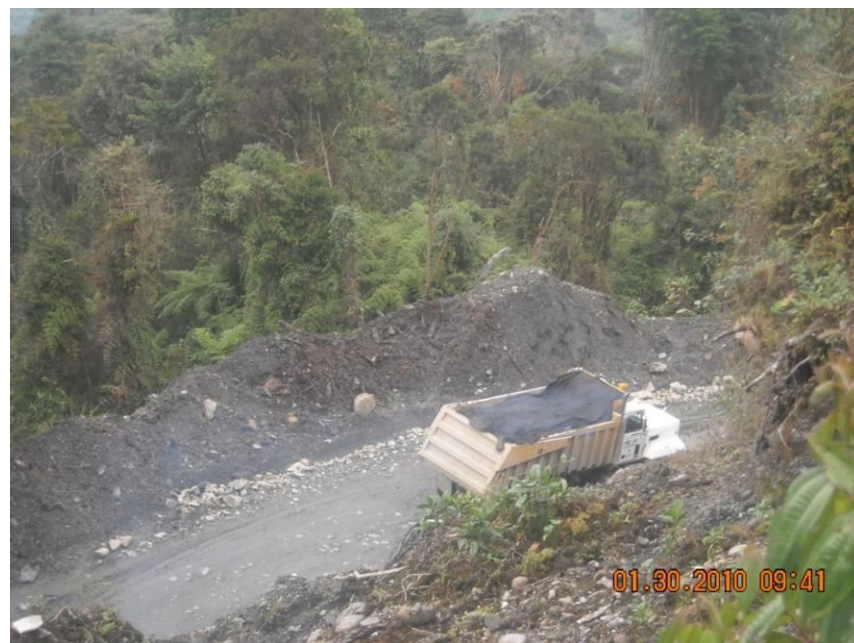
VISTA DE LA FALLA EN EL SECTOR DENOMINADO CÓRDOBA
