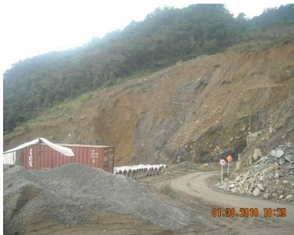
VISTA DE LA FALLA EN EL SECTOR CÓRDOBA
