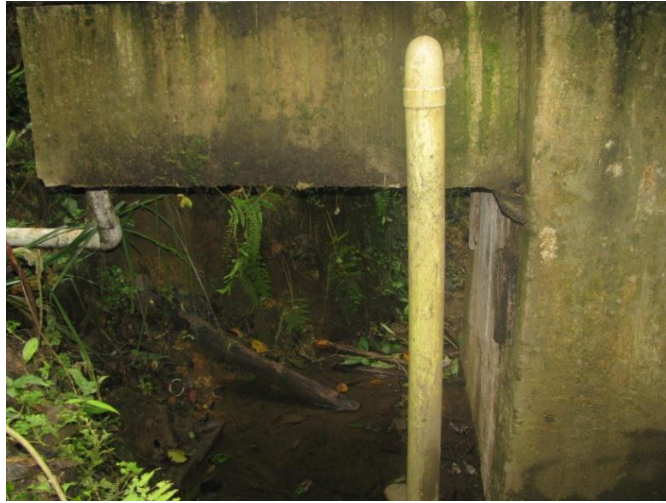
Figura 27. Falta de Soporte de Apoyo en la cámara de entrada al desarenador
