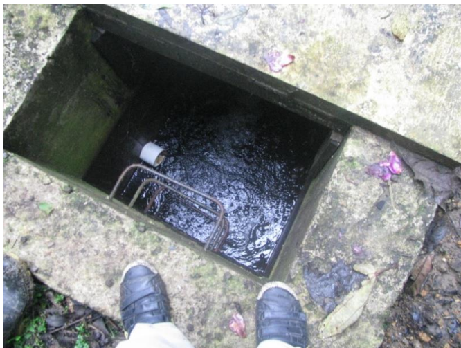
Figura 26. Desarenador – Vereda San Isidro
