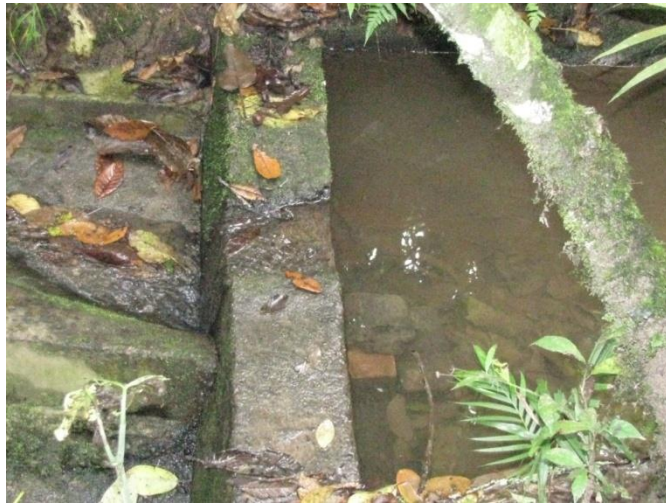
Figura 8. Bocatoma Fuente alterna Tanque de almacenamiento vereda Los Llanos
