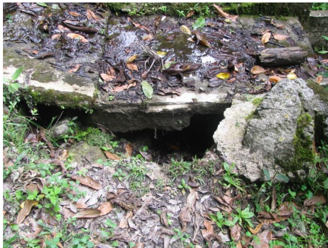
Figura 47. Daños en el canal de conducción por socavación del lecho
