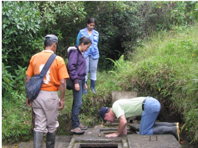
Figura 14. Desarenador acueducto principal veredas Las Huacas y Los Llanos
