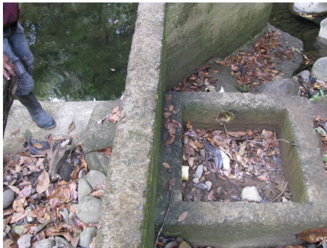
Figura 36. Cámara de derivación sin funcionamiento
