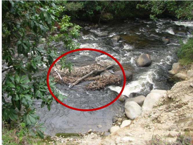
Figura 46. Gaviones arrasados por la corriente del Río
