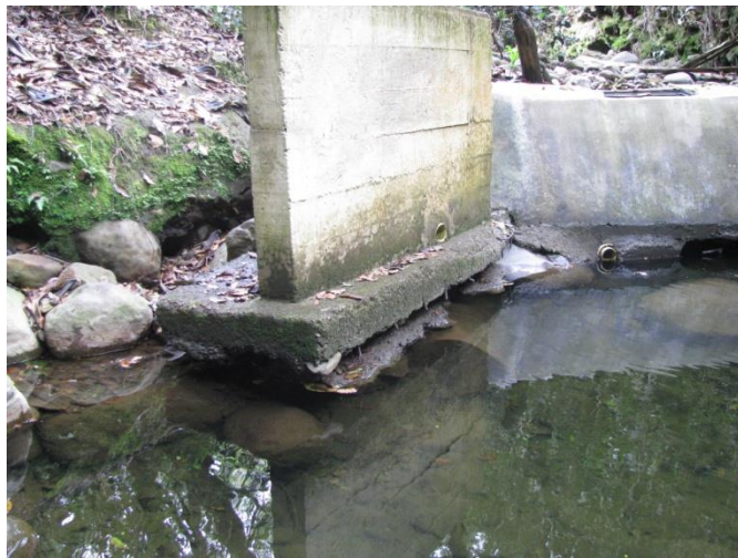
Figura 33. Daños en la Cimentación de la Bocatoma
