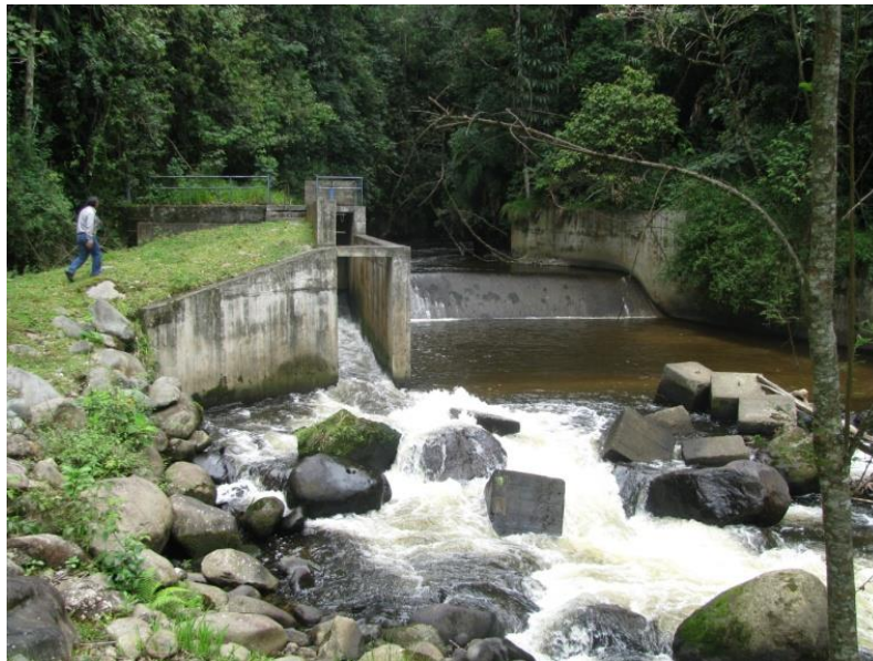
Figura 45. Bocatoma Río Palacé
