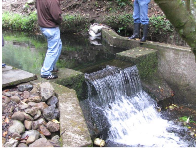
Figura 13. Bocatoma Principal del Acueducto de las veredas Las Huacas y Los Llanos
