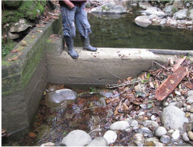
Figura 35. Filtración de la fuente por en medio de la estructura
