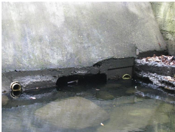
Figura 34. Daños en la Cimentación de la Bocatoma
