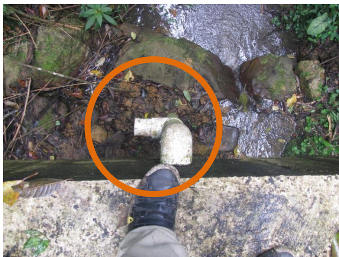
Figura 29. El desarenador no cuenta con línea de aducción.
