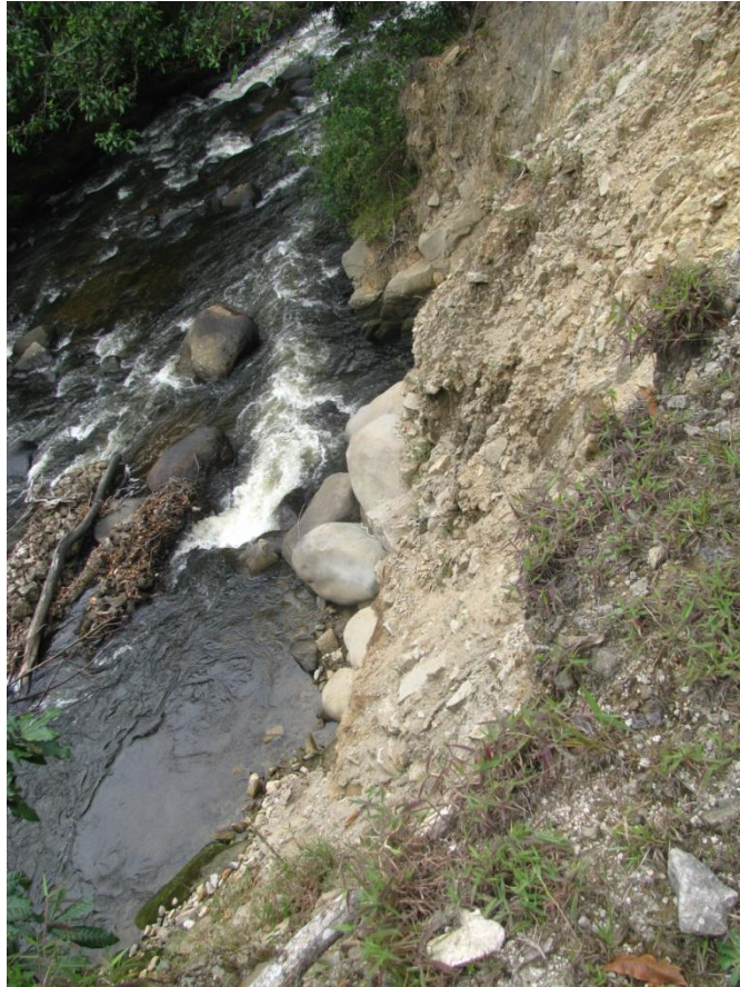
Figura 48. Socavación de la ladera
