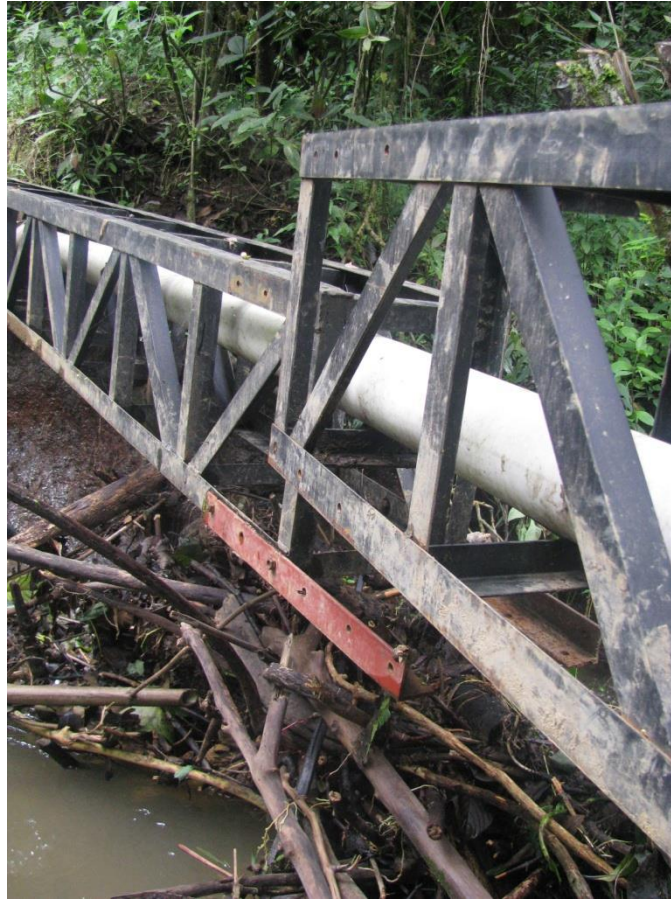
Figura 53. Viaducto afectado por falta de tornillos de aseguración.
