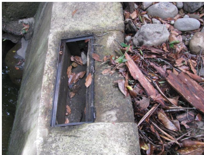
Figura 37. No existe Rejilla de captación
