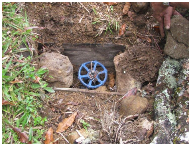
Figura 12. Válvula Reguladora de caudal en la derivación de la red de distribución del acueducto veredal
