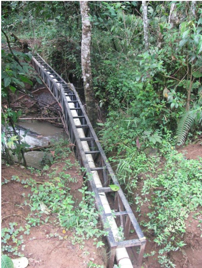
Figura 52. Viaducto afectado por falta de tornillos de aseguración.
