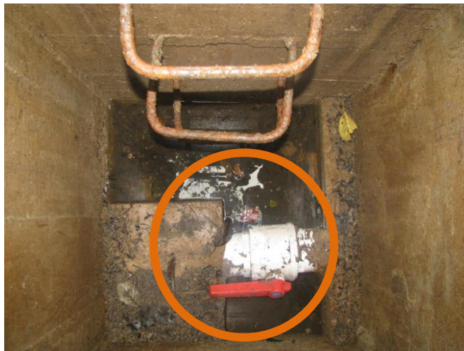
Figura 28. Válvulas en el Desarenador mal colocadas
