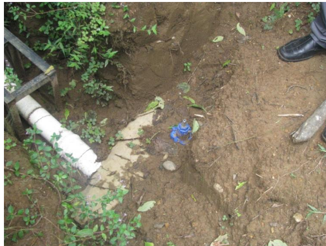
Figura 54. Válvula afectada por el movimiento del viaducto
