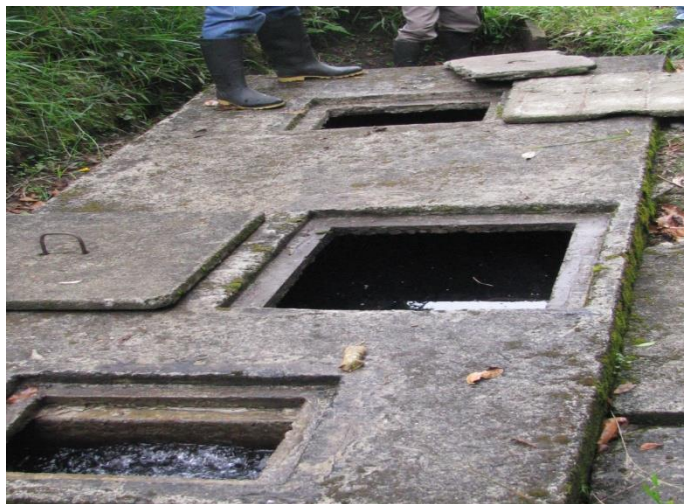
Figura 15. Desarenador acueducto principal veredas Las Huacas y Los Llanos
