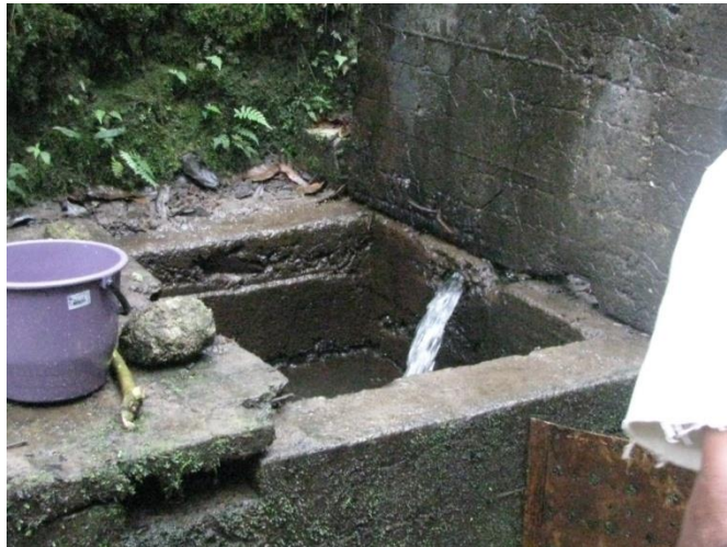
Figura 11. Desarenador Fuente alterna Vereda “Los Llanos”
