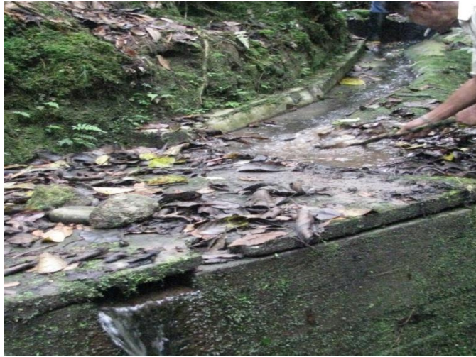
Figura 10. Desarenador Fuente alterna Vereda “Los Llanos”
