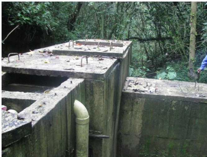
Figura 25. Desarenador – Vereda San Isidro
