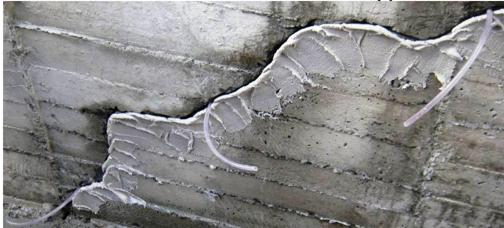
IMAGEN 23. SUBSANE DE LA VIGA (1)
