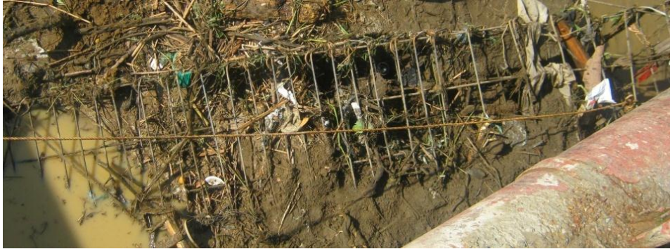
IMAGEN 12. REFUERZO DE VIGA DESTRUIDO POR LA CRECIENTE
