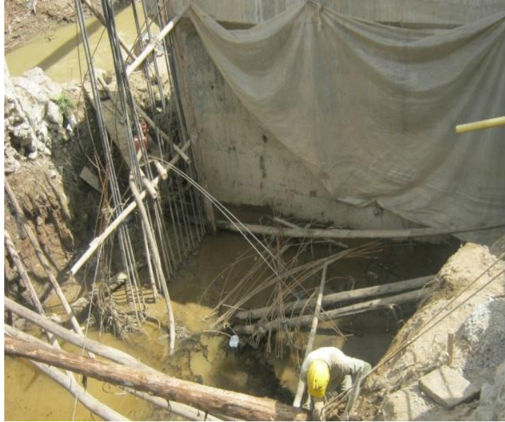
IMAGEN 3. INUNDACION DE LA EXCAVACION DEL ESTRIBO
