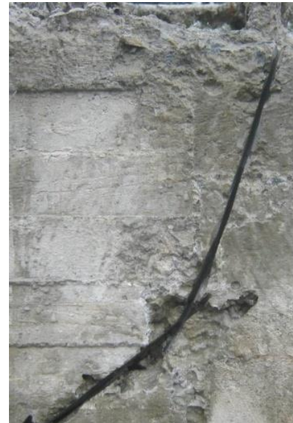
IMAGEN 21. FISURA DE LA VIGA (2)
