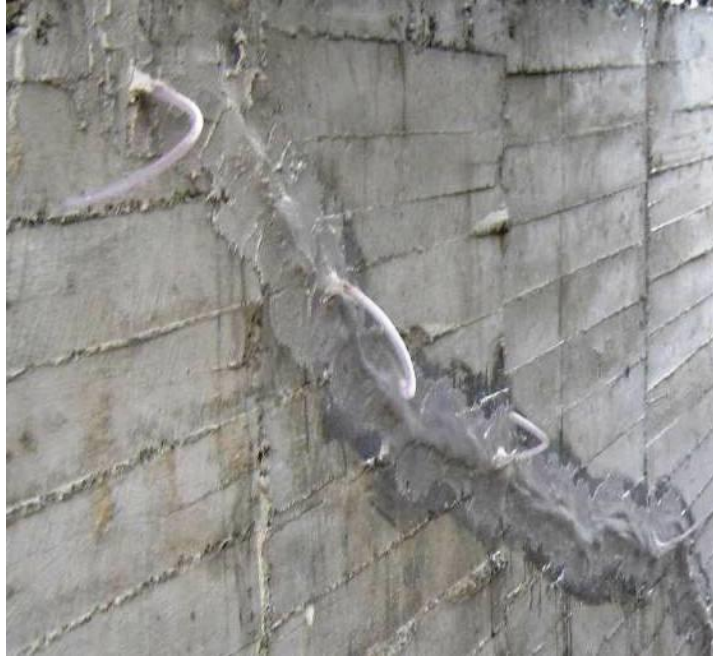
IMAGEN 24. SUBSANE DE LA VIGA (2)
