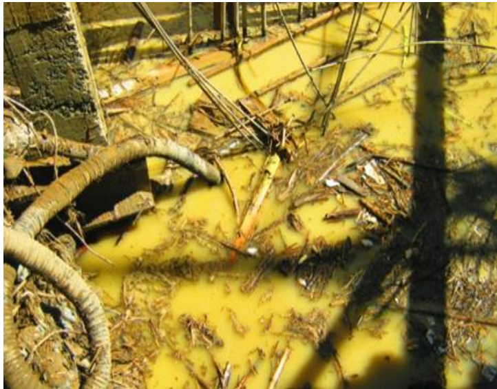
IMAGEN 4. ESCOMBROS EN LA EXCAVACION DEL ESTRIBO
