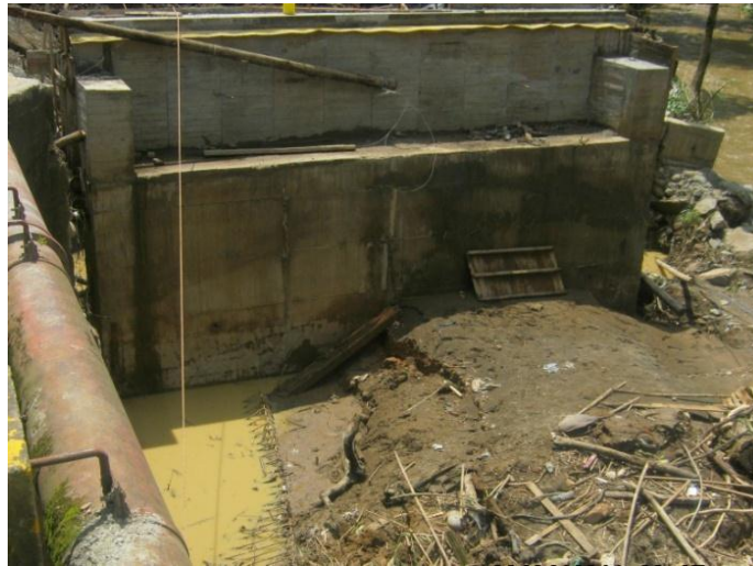
IMAGEN 14. ESTRIBO NORTE DESPUES DE LA AVALANCHA
