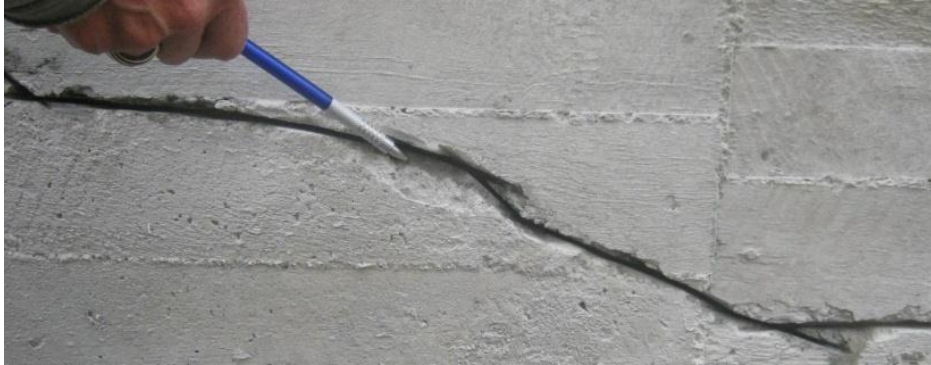
IMAGEN 22. FISURA DE LA VIGA (3)
