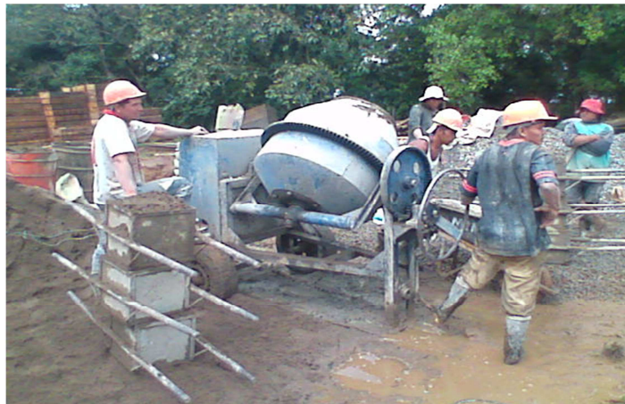
Figura 7. Maquina mezcladora de concreto.
