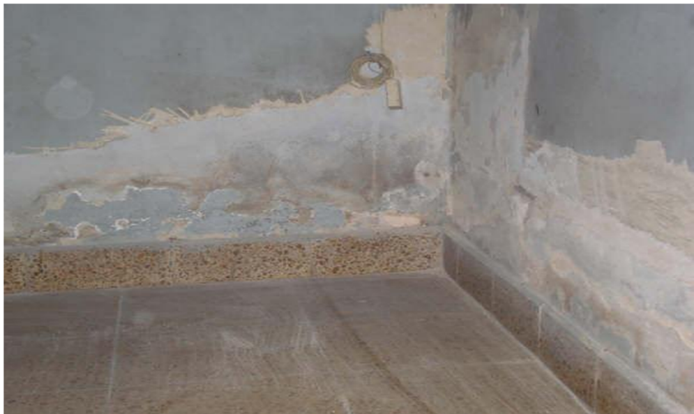
Figura 49. Humedad en muros de la casa 28.
