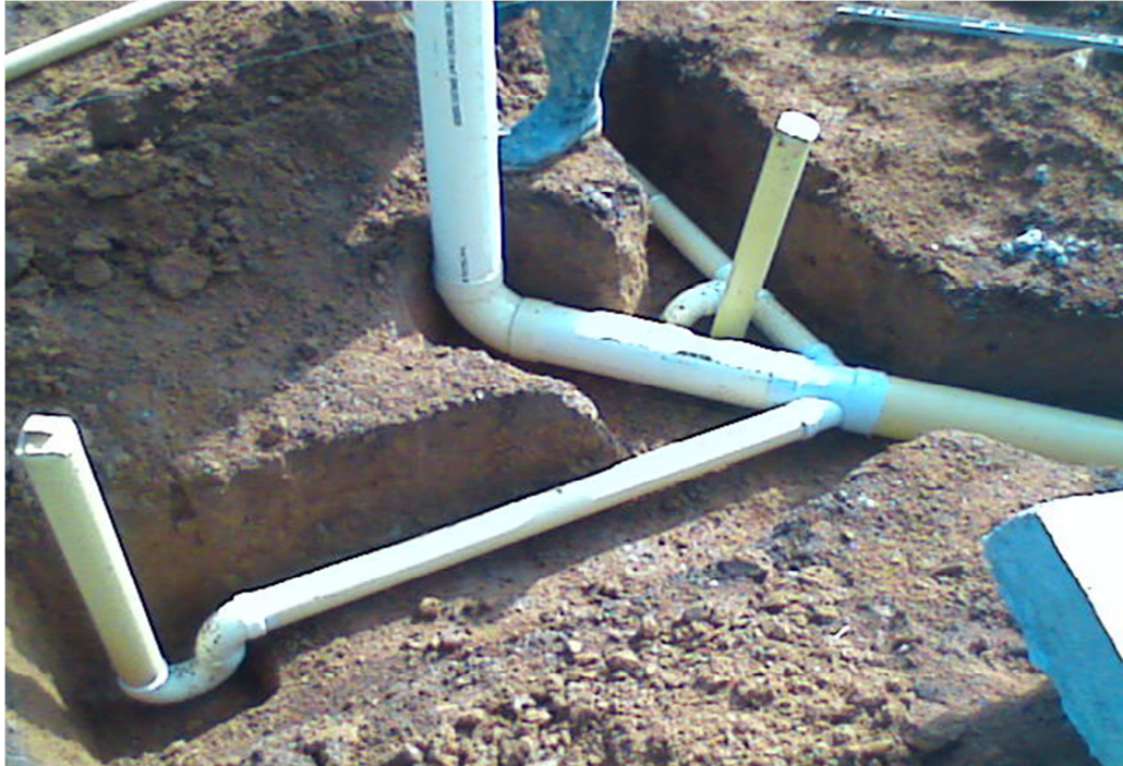
Figura 17. Tubería de desagüe.
