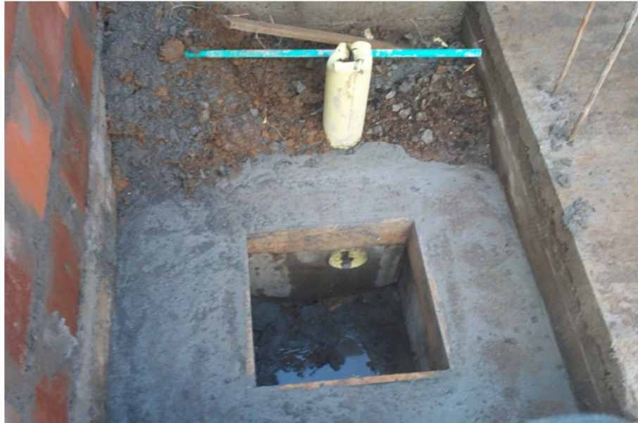
Figura 18. Caja de inspección sanitaria.
