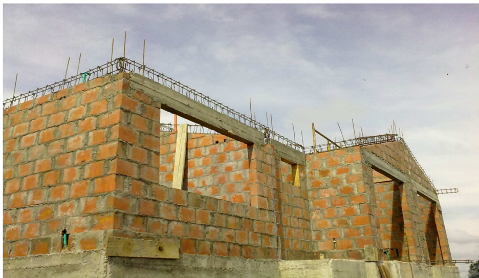
Figura4 35. Separación de estribos.
