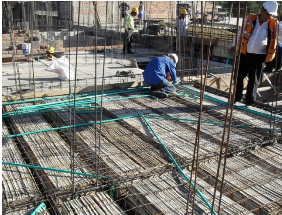
FIGURA 76 Identificación de puntos eléctricos
