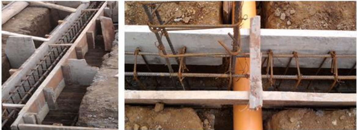
FIGURA 30 Chequeo de separación del acero a la formaleta, la verticalidad y alineación de los tableros de la formaleta
