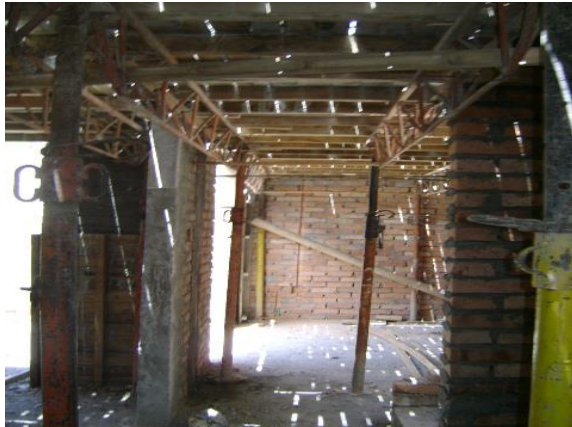
FIGURA 66 Colocación de los tacos o gatos metálicos de la estructura de soporte
