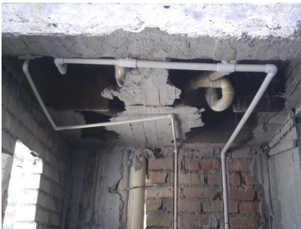
FIGURA 94 Instalación suspendida de la red de tubería hidráulica, sección patio de lavado
