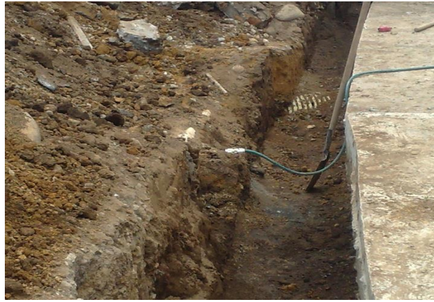
Foto No. 4 Red provisional hidráulica
