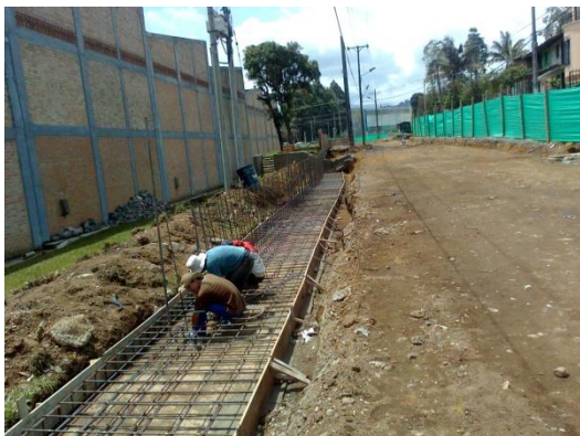
Foto No. 22 Amarrado de acero para muro de terminada muro de contención
