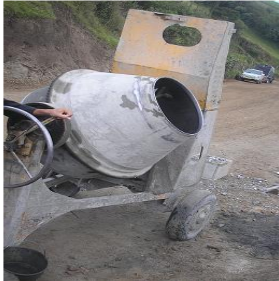
Figura 35. Mezcladora de Concreto
