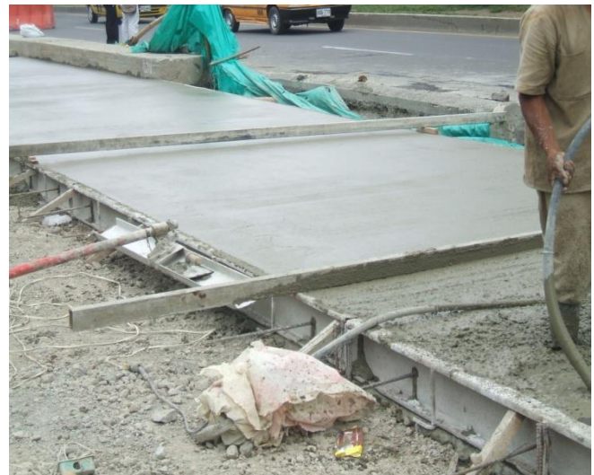
Fotografía 16: Terminado con flotadora de la losa de concreto – Carrera 17 con Calle 7 costado Suroccidental.
