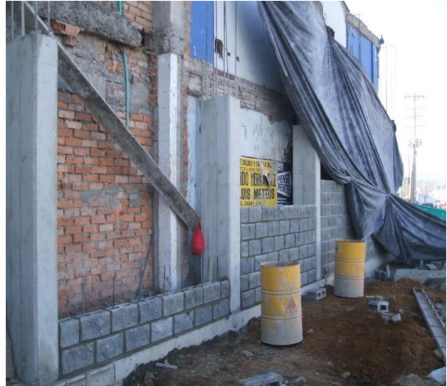
Fotografía 43: Mampostería Carrera 17 entre calles 4 y 5.
