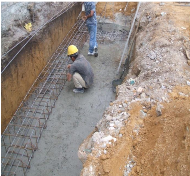
Fotografía 38: Amarre de acero Carrera 17 entre calles 4 y 5.
