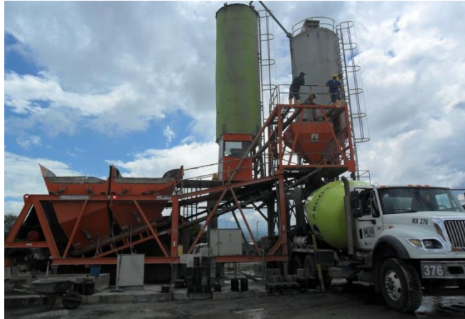
Fotografía 1: Instalaciones Planta PREDELCA que suministró el concreto hidráulico.
