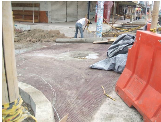
Fotografía 20: Apariencia de la losa con el agente curador curador - Carrera 17 con Calle 6B esquina costado Suroccidental.
