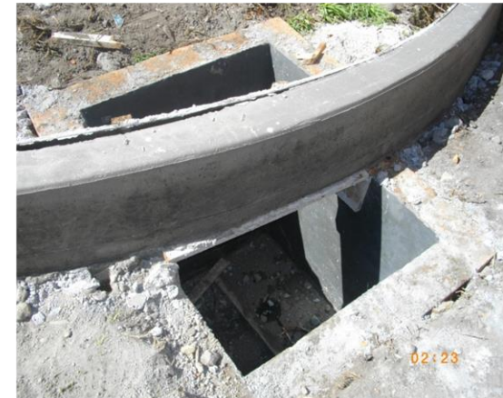
FOTO 76. CAJA DE PASO Y BORDILLO
