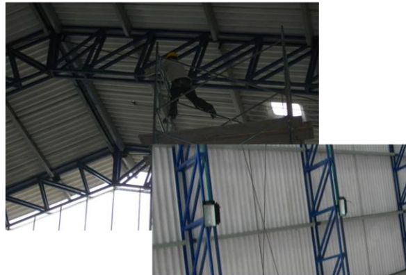
FOTO 22 Y 23. INSTALACIONES ELECTRICAS-REFLECTORES 400WT Y TUBERIA CONDUIT INTERIOR COLISEO
