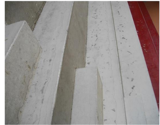
FOTO 5. DETERIORO GRADERIA INTERNA COLISEO
