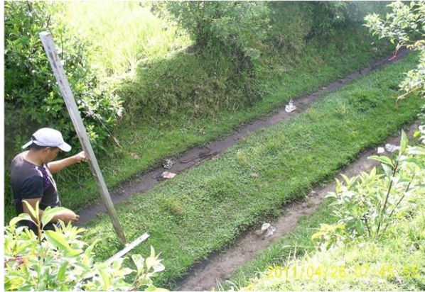
FOTO 6. TOMA DE MEDIDAS DE LA VIA QUE SE VA A AMPLIAR EN 1.2 m
