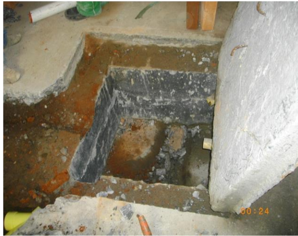
FOTO 26. INSTALACIONES SANITARIAS BATERIA
