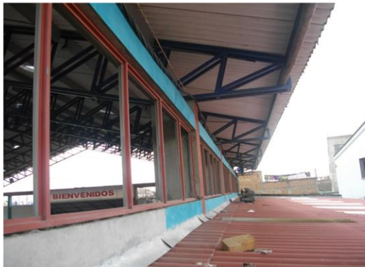
FOTO 6. MARCOS ABANDONADOS CON ANTICORROSIVO SIN PROTECCION AL EXTERIOR
