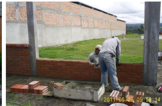
FOTO 30. SUMINISTRO E INSTALACION DE LADRILLO VISTO SEGUN PLANOS ARQUITECTONICOS EN LA PARTE FRONTAL DE LA IPS
