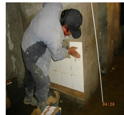
FOTO 31. ENCHAPE BATERIA SANITARIA
