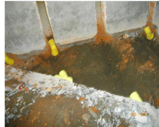
FOTO 27. INSTALACIONES SANITARIAS BATERIA
