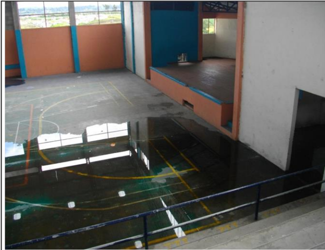
FOTO 4. ENTRADA DE AGUA A LA CANCHA-DETERIORO GENERAL
