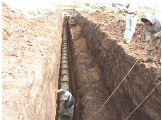
Foto 6. Tubería de mortero de 14"
