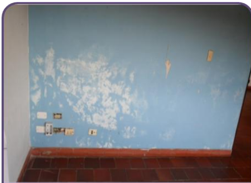
figura 11. UBICACION: Edificio Administrativo PROCESO: Estado inicial de las paredes internas a resanar y pintar.
