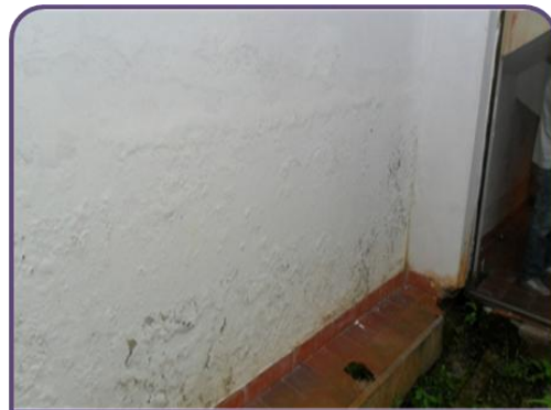
figura 12. UBICACION: Interior Edificio Administrativo PROCESO: Estado inicial de las paredes internas a resanar y pintar.
