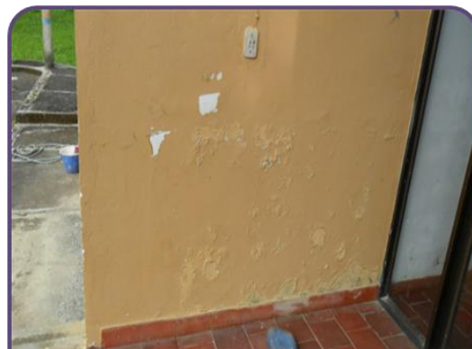
figura 14. UBICACION: fachada interior Edificio Administrativo PROCESO: Estado inicial de las paredes internas a resanar y pintar.
