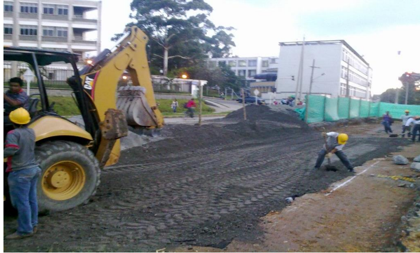
Figura 35. Material de Sub-base de reemplazo en fallo.
