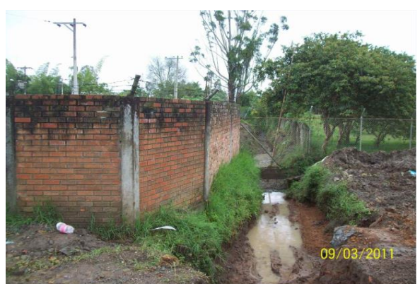
Figura 7. Estancamiento aguas lluvias.
