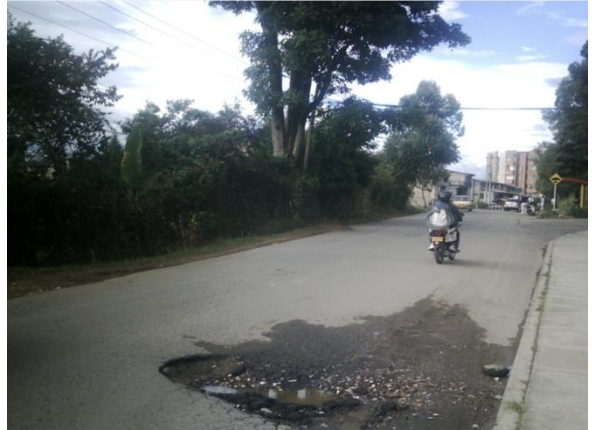
Figura 3. Deterioro de la vía.
