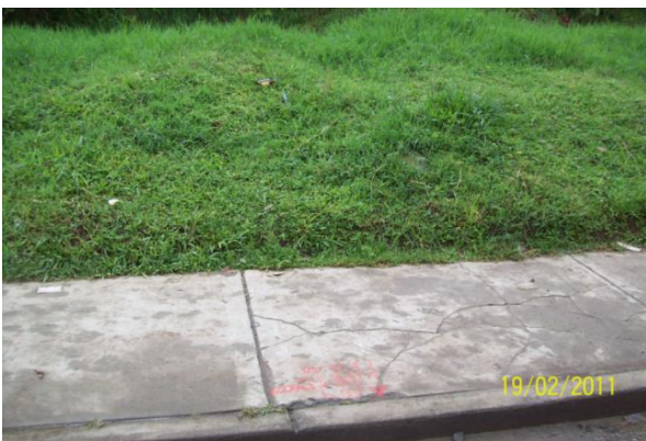
Figura 6. Deterioro Andenes existentes.
