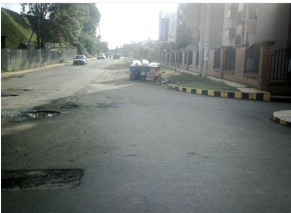
Figura 4. Deterioro de la vía.
