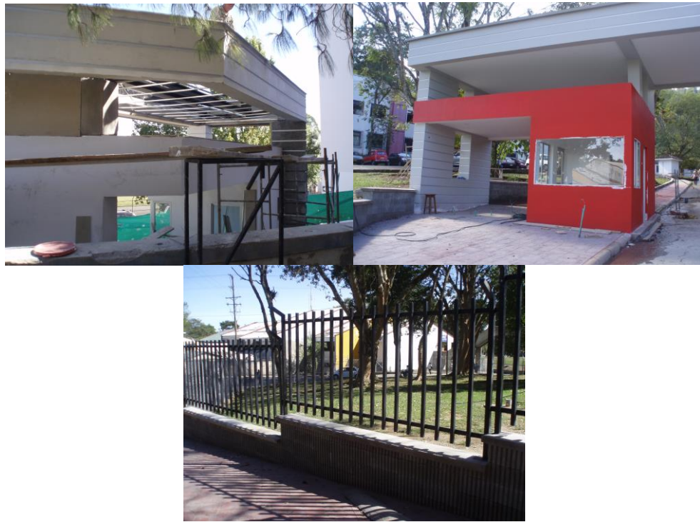
FIGURA 19. Estructura de cubierta Porteria Central, Reja y acabados Porteria Sur de Ingenierias
