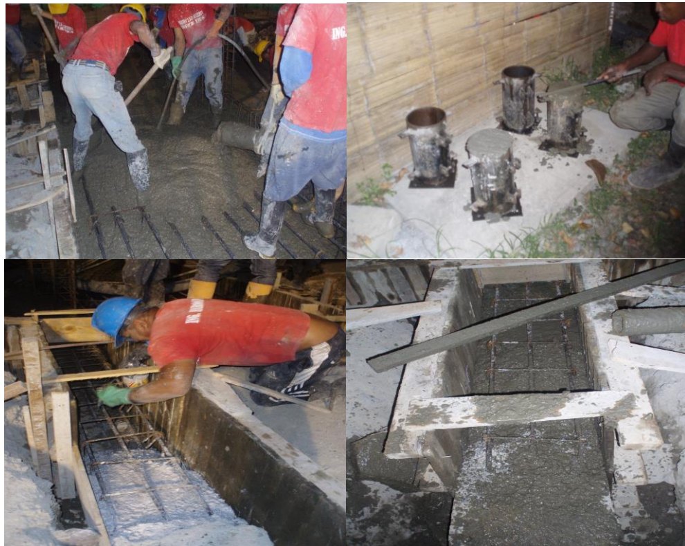
FIGURA 40. Vibración del concreto, cilindros para pruebas de resistencia y aplicación de componentes para la unión de concreto viejo y nuevo
