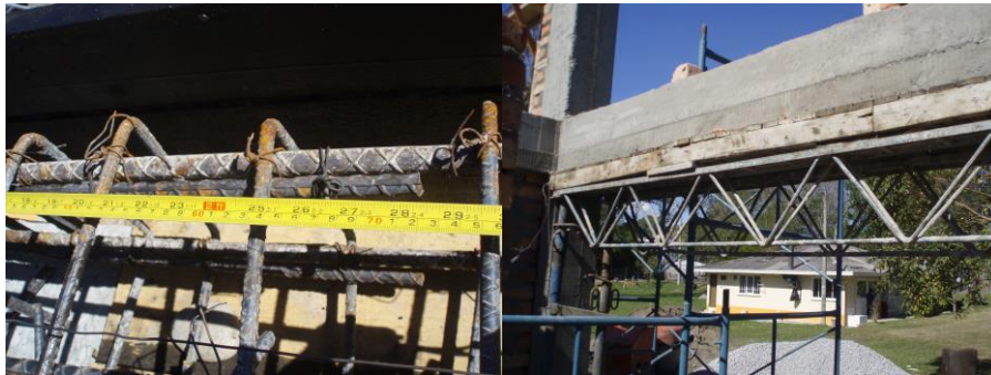
FIGURA 28. Chequeo separación del refuerzo en las vigas y desencoframiento de las mismas
