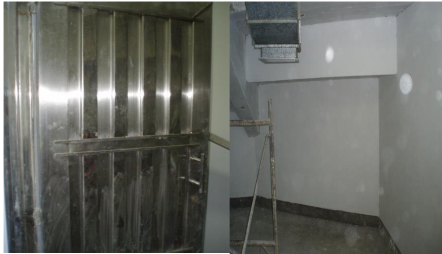
FIGURA 32. Cambio de puerta antigua por una en acero inoxidable y aplicación de pintura epoxica en los muros
