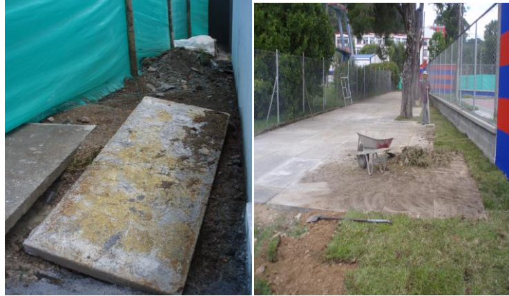
FIGURA 16. Movimiento de placas en el acceso de las canchas
