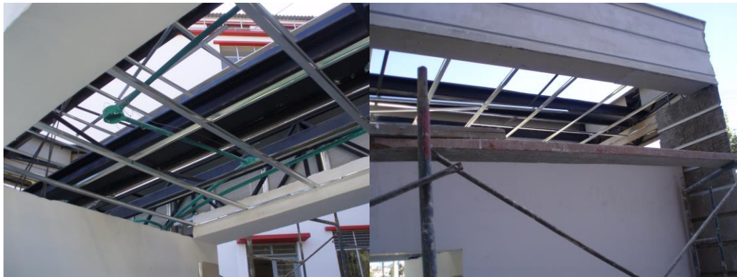
FIGURA 18. Estructura cielo falso Porteria Central de Ingenierias
