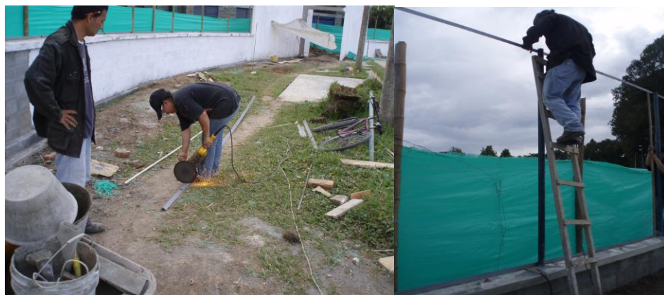
FIGURA 15. Falta de implementos de protección
