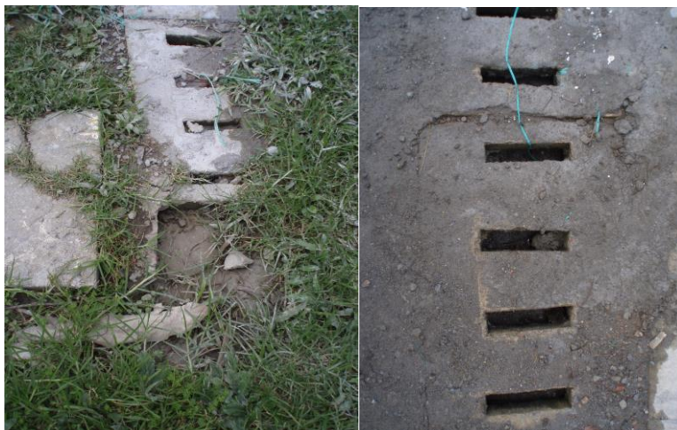
FIGURA 14. Tapas de canales en mal estado
