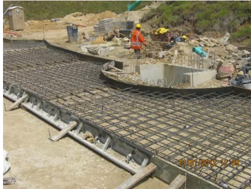
Fotografía 27. Placas reforzadas por geometría irregular.
