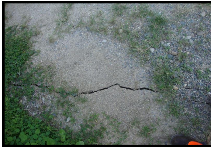
7.Fotografía -Fisura en la Corona del Talud-
