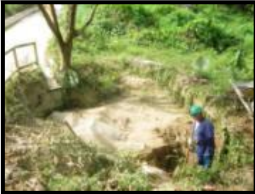
38.Fotografía -Alcantarilla con Sedimentos-
