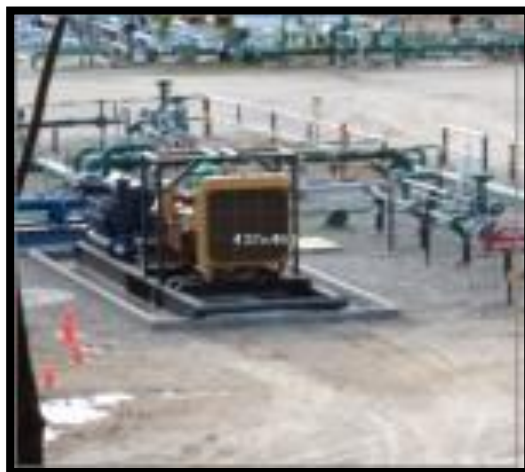
31.Fotografía -Bomba Instalada-
