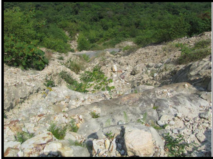
3.Fotografía -Afloramiento de la Roca en el Deslizamiento-
