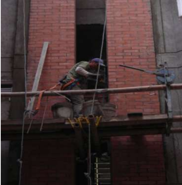
Fotografía 2. Repellos de antepechos zona interior de la Torre A
