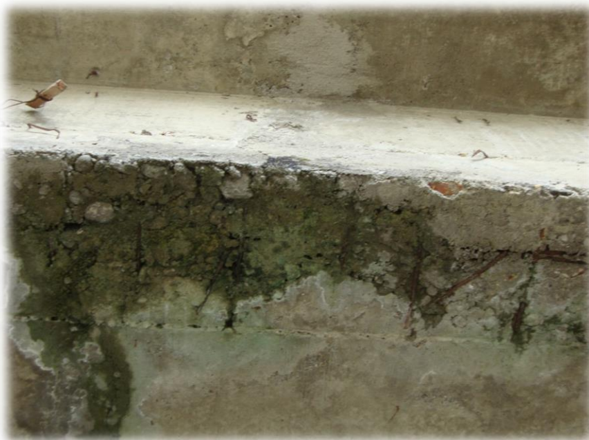
Fig. 9. Humedad y exposición de acero en tribuna occidental módulo 1.
