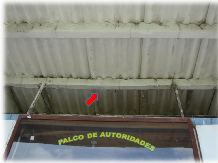
Fig. 3. Deflexión en vigas de cubierta.
