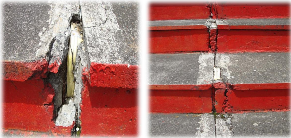
Fig. 13, 14, 15, 16. Junta de dilatación en cambio de modulo.
