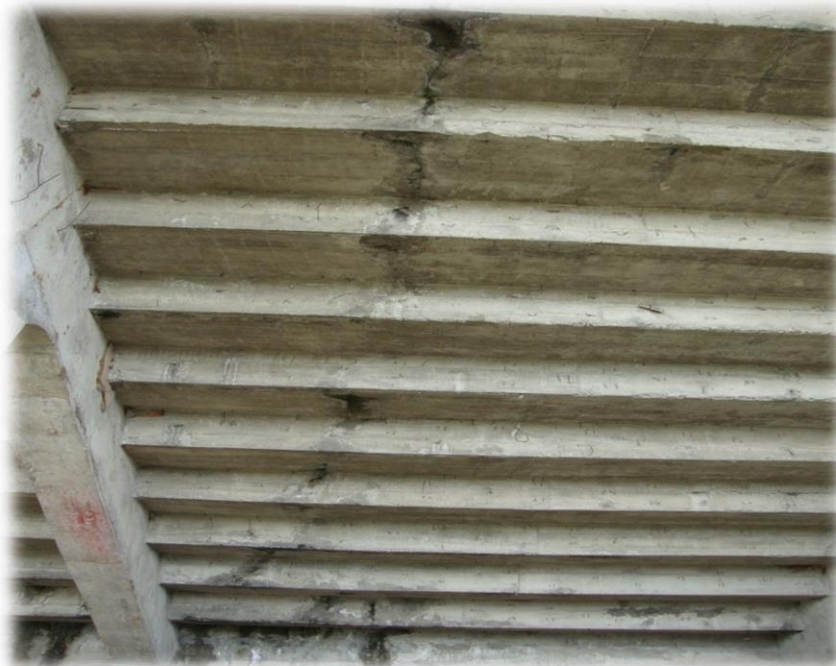
Fig. 11. Humedad en junta de dilatación tribuna entre módulo 3 y central
