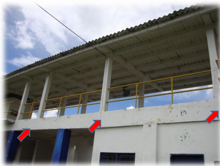
Fig. 2. Discontinuidad en las columnas
