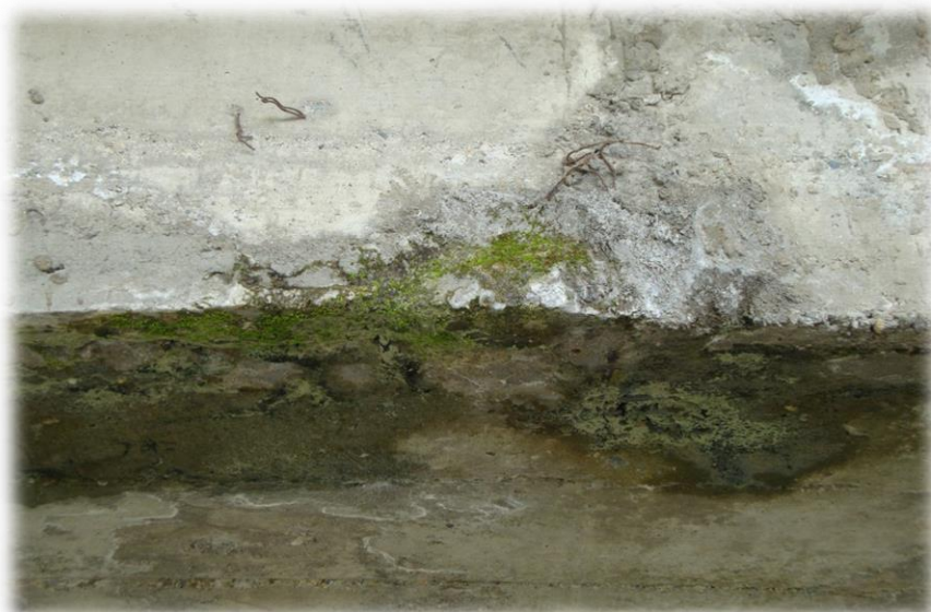
Fig. 8. Humedad en la tribuna occidental módulo 1
