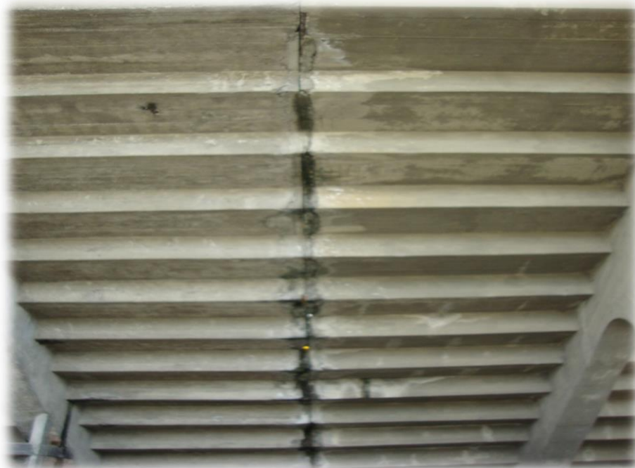
Fig. 12. Humedad en junta de dilatación entre los módulos 1 y central de la tribuna occidental.
