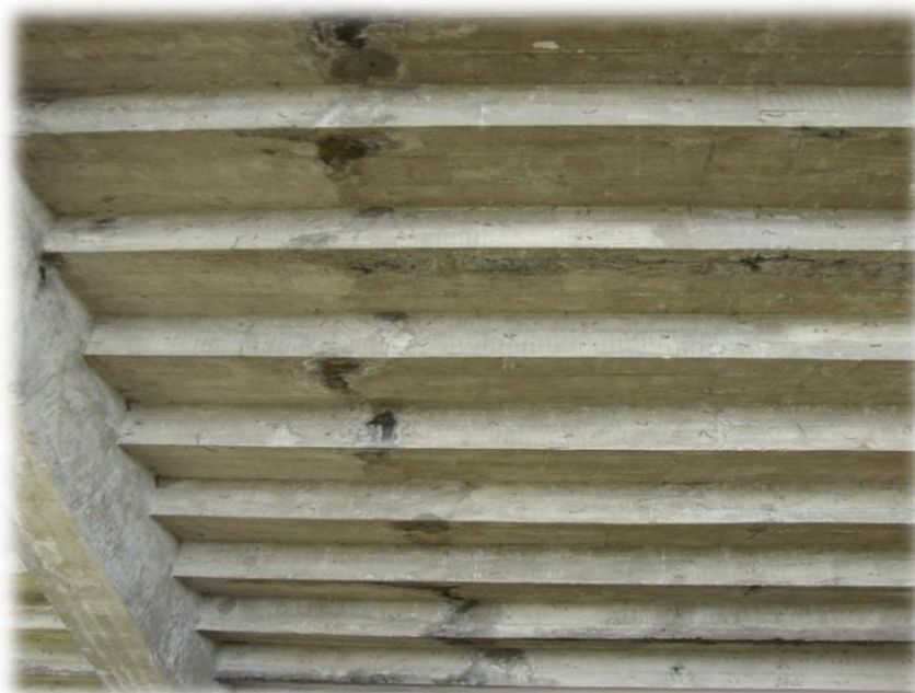
Fig. 10. Humedad en graderías sobre tribuna occidental módulo central (Parte superior)
