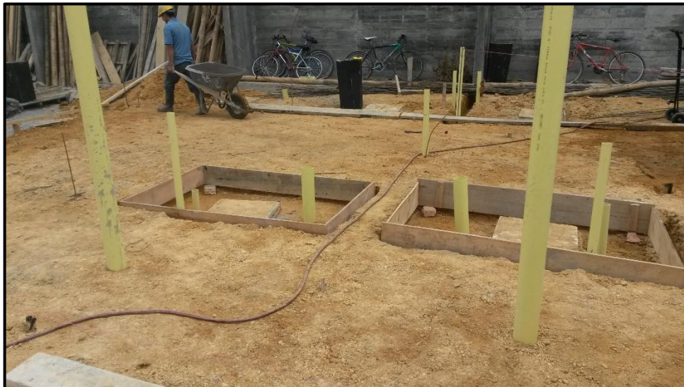
Figura 8 - Red de alcantarillado de terraza. Fuente: Fotografía tomada por la pasante
