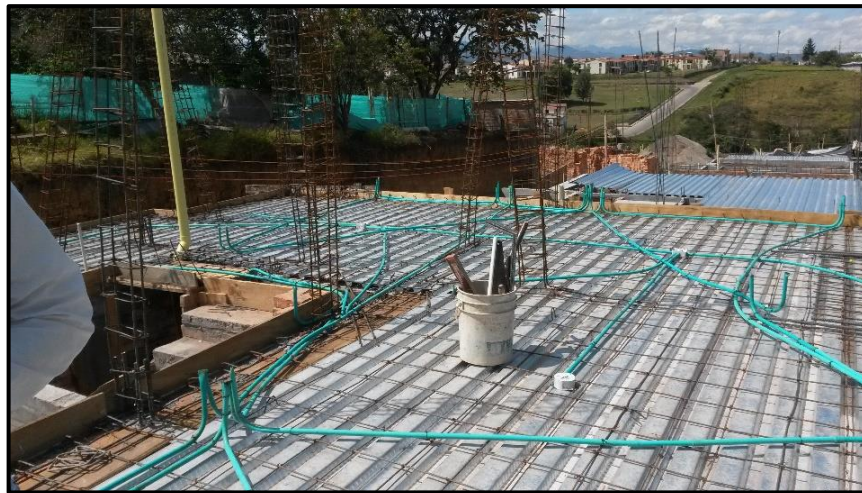
Figura 30 - Losa de entre piso antes de fundir. Fuente: Fotografía tomada por la pasante
