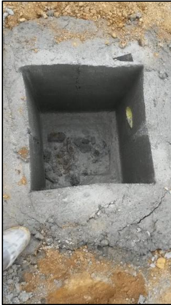
Figura 50 - Caja fundida. Fuente: Fotografía tomada por la pasante
