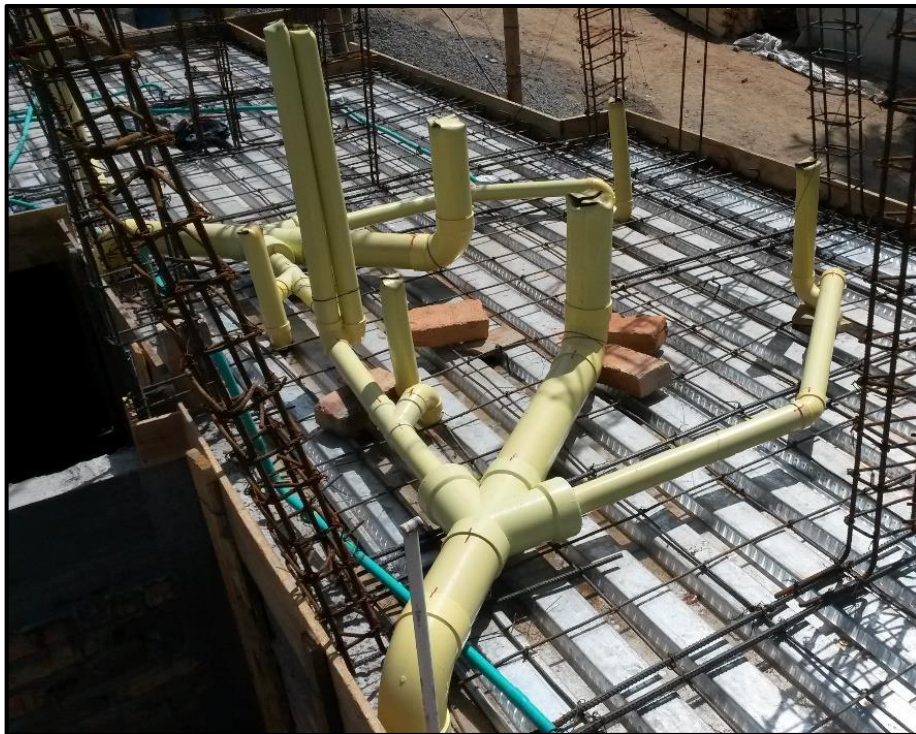
Figura 29 - Tubería sanitaria baño segundo piso. Fuente: Fotografía tomada por la pasante
