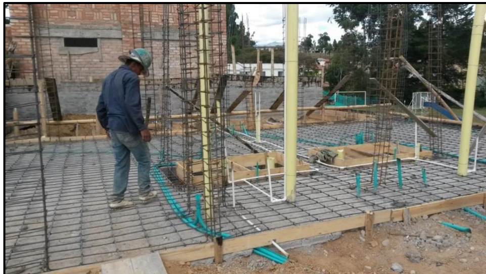
Figura 11 - Cimentación según diseño estructural del ingeniero civil Carlos Ariel Hurtado. Fuente: Fotografía tomada por la pasante
