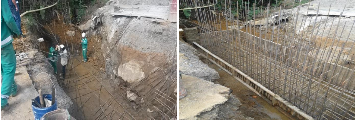
Imagen No. (80 y 81) instalación de acero de la losa y paredes del box coulvert.
