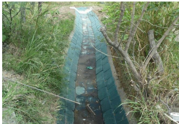
Imagen No. 65 cuneta flexible anclada al terreno.
