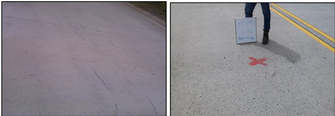
Imágenes No.17. Patologías de pavimento rígido
