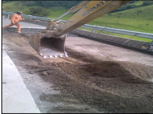
Imagen No.66 Extracción de fallo K34+347
