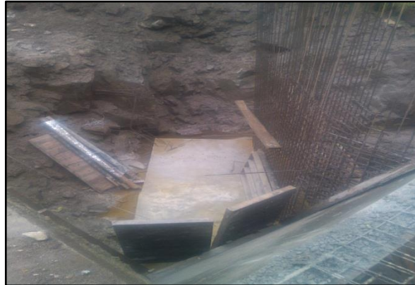
Imagen No.37. Perforaciones de contrafuerte muros de contención del Box coulver k34+190
