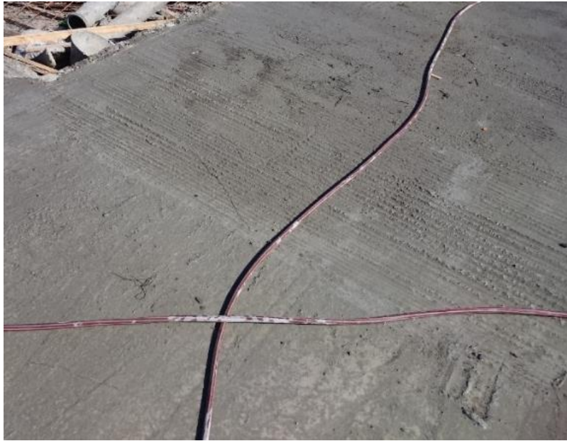
Figura No. 13 Fisuras en la cubierta
