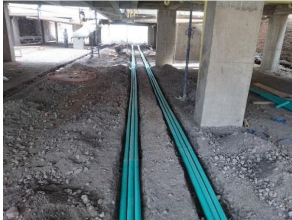
Figura No. 25 Tuberías área parqueadero T-A
