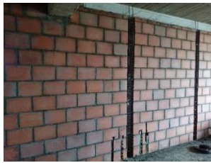
Figura No. 52 Muro con regatas
