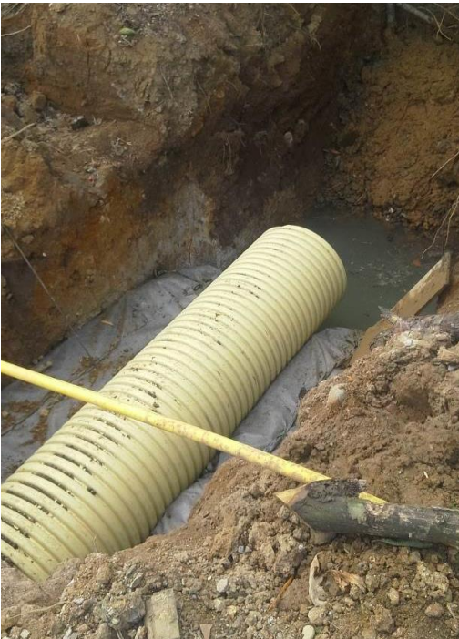
Figura 53. Tubería de 24 in.
