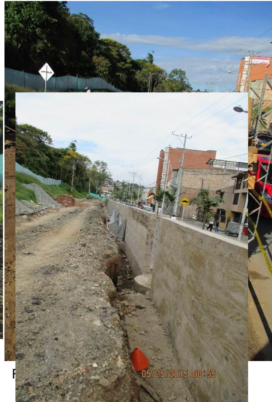
Figura 09. Muro sin fundir en cámara de inspección.
