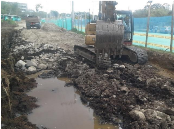
Figura 23. Agua represada en excavación.
