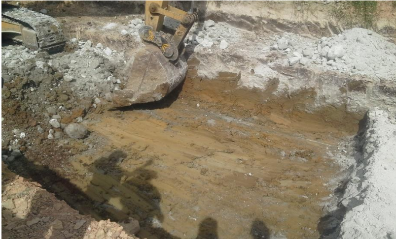
Figura 60. Fallo con presencia de material arcilloso.
