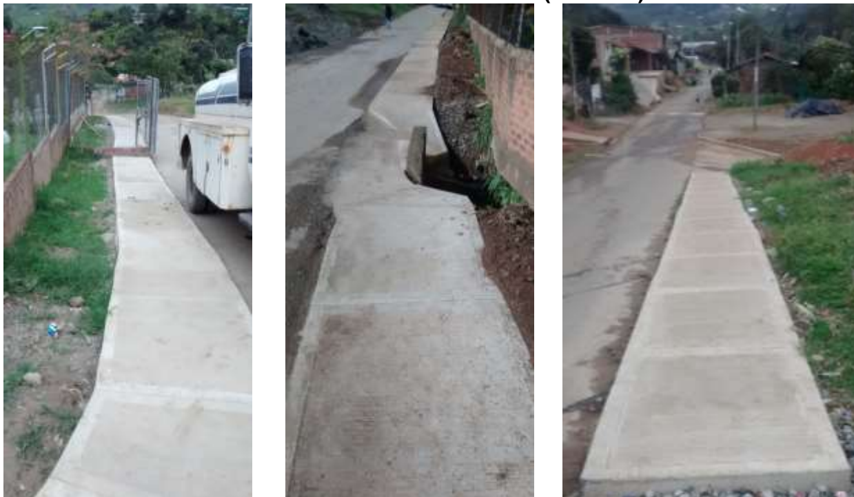
Imagen 5.54. Andén Tramo Muro Santa Teresita Terminado. (Izquierda y Centro). Andén Tramo Final Terminado. (Derecha)
