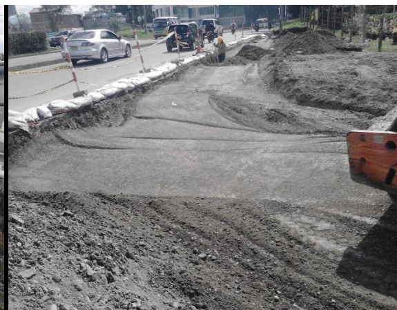
Figura 62. Conformación fallo calzada sur
