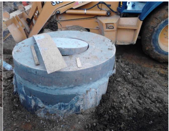
Figura 50. Brocal sobre la cámara de inspección
