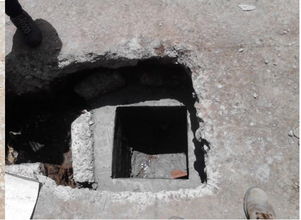
Figura 44. Caja domiciliaria agua sanitaria
