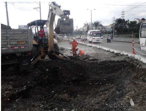
Figura 61. Fallo transición calzada sur
