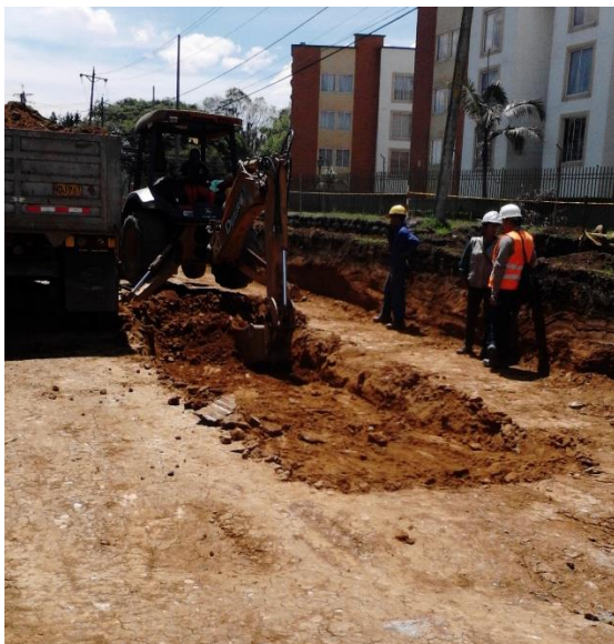
Figura 47. Sacando el fallo en la calzada norte
