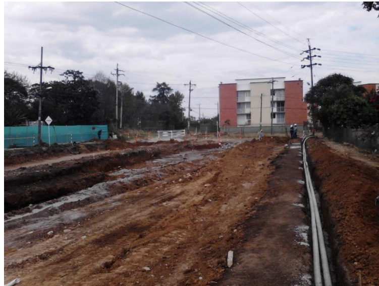
Figura 22. Cajeo sobre calzada norte PR0+110 a PR0+140.
