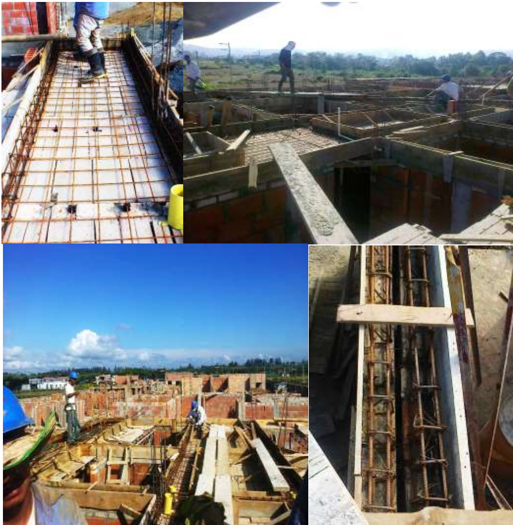
FIGURA No. 51 Encofrado y colocación del acero en la losa de cubierta.
