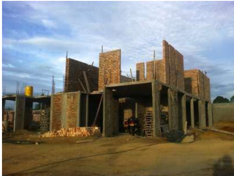
FIGURA No. 49 Mampostería segundo piso, sin confinamiento
