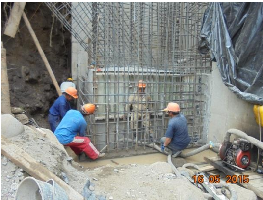
Instalación y amarre de acero de refuerzo para terminación de pantalla y contrafuerte del segundo anillo del cajón derecho
