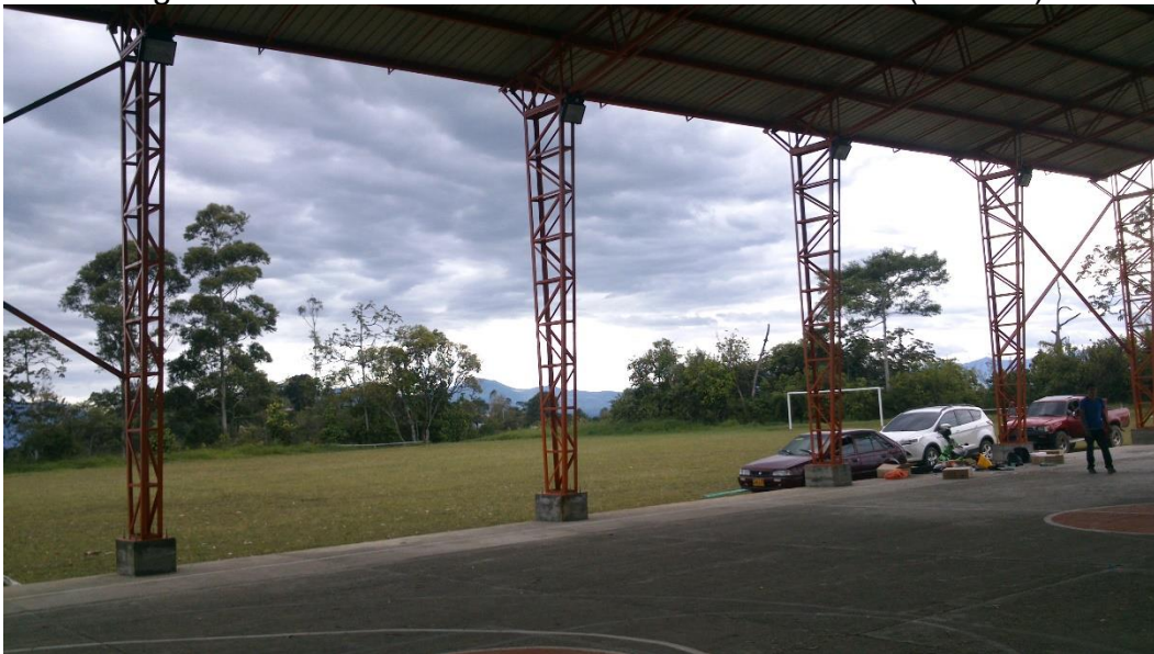
Figura No. 12 Reflectores Metal Halide instalados (Oriente)
