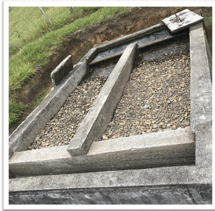
Figura 8. Unidades de FGD i operando sin nivel superficial de agua.
