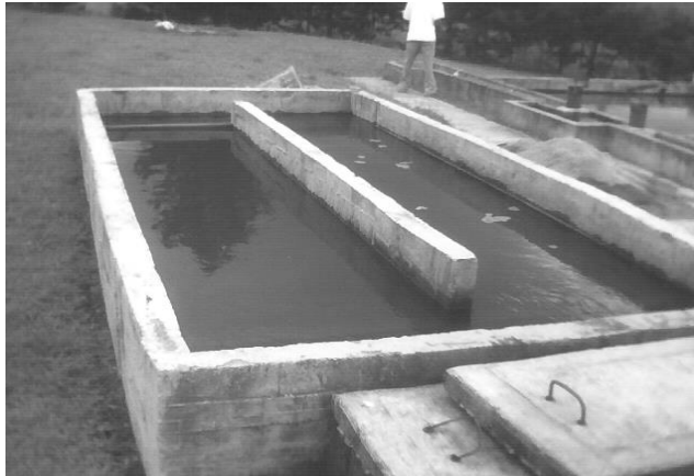
Figura 4.1 Filtros Gruesos Dinámicos, FGD i , operando en paralelo. Planta de tratamiento la Venta Cajibío, 2005.
