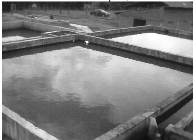
Figura 4.2 Filtro Grueso Ascendente en Capas, FGAC, con dos unidades en paralelo. Planta de tratamiento La Venta Cajibío, 2005.
