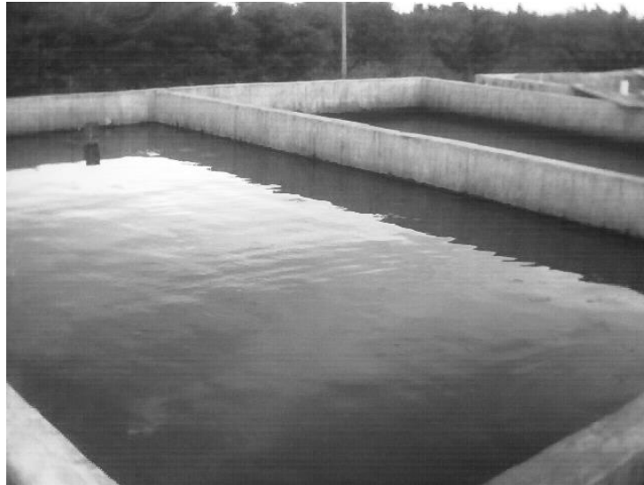
Figura 4.3 Filtro Lento en Arena, FLA, con dos unidades en paralelo, mas ampliación de otras dos unidades. Planta de tratamiento La Venta Cajibío, 2005.
