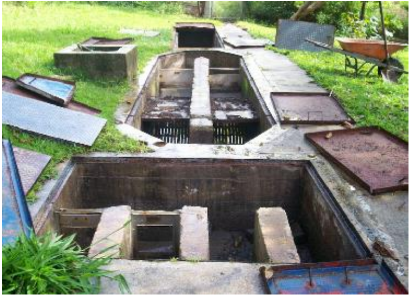
Fotografía 1. Aliviadero – Canal de rejas – Distribución del flujo
