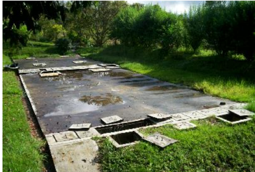
Fotografía 4. Tanques Sépticos – Filtros Anaerobios
