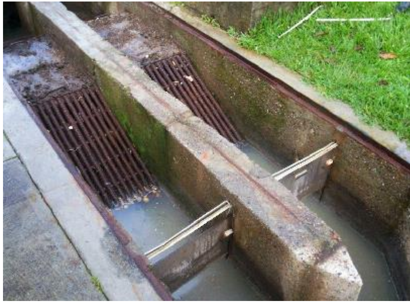
Fotografía 3. Canal de rejas
