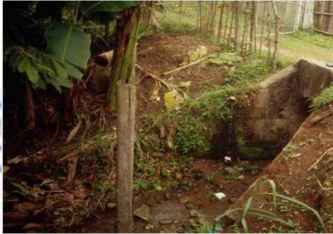
Fotografía 3. Salida del efluente de la PTAR a la fuente receptora.
