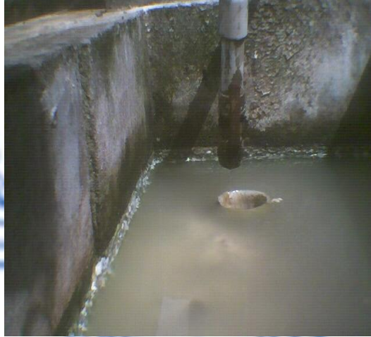
Figura 18. Entrada al filtro
