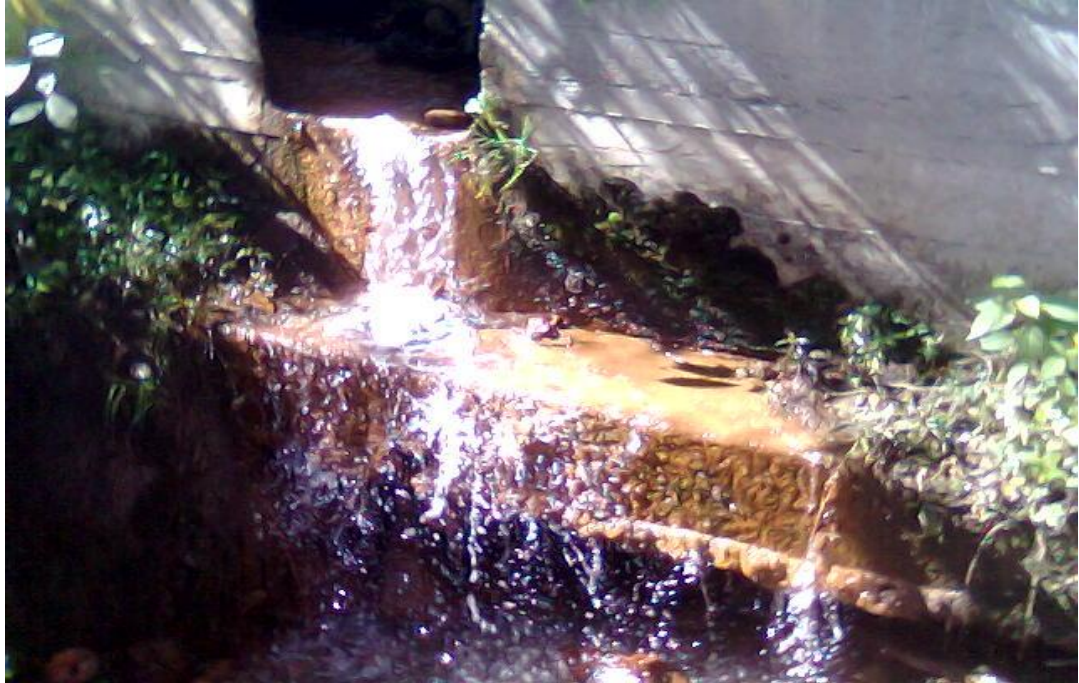
Foto 7. Detalle del efluente en operación normal.
