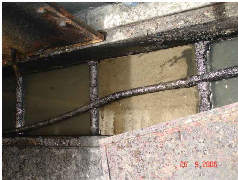
Foto 2. Canaleta de conducción de cuarto de máquinas
