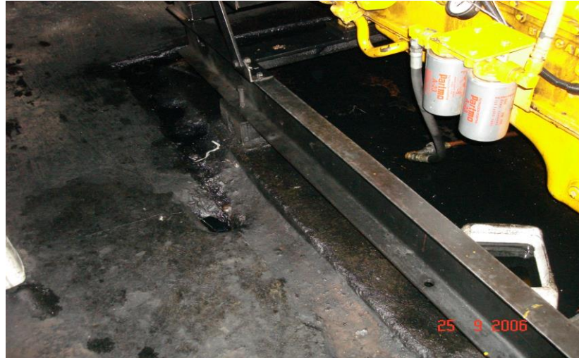
Foto 1. Derrame de aceite Cuarto de máquinas
