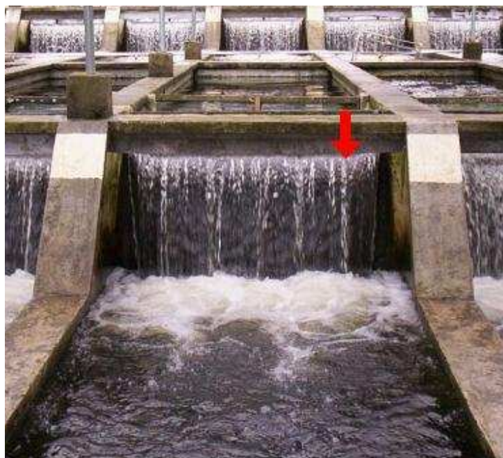
Figura 14. Entrada de agua al estanque.
