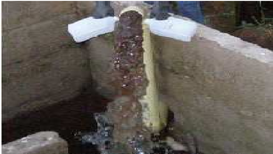
Figura 2. Final de tubería de adaptación salida de lodos
