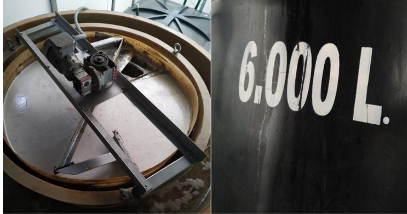
Figura 9. Sistema DAF y tanque de acondicionamiento y bombeo
