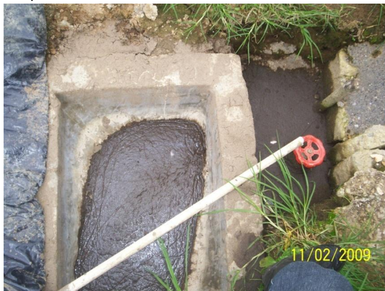
Figura 10. Caja de inspección para evacuación de lodos
