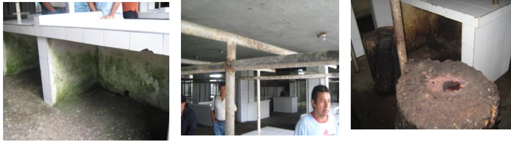
Fotografías 67,68 y 69 Pisos con agua estancada, Humedad en las paredes, tubos oxidados, agua sangre estancada en troncos de madera utilizados para corte y plafones en mal estado en el área donde se comercializa la carne a la comunidad.
