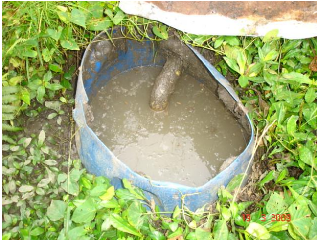
Figura 24. Trampa de grasa. Vereda de Providencia (ASPROSI)
