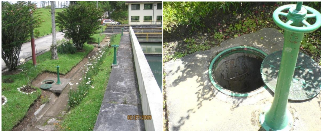
Figura 35. Canal de desagüe de la planta
