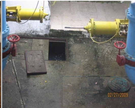
Figura 41. Tanque de contacto
