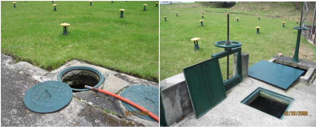
Figura 61. Tapas de acceso a los tanques de almacenamiento abiertas
