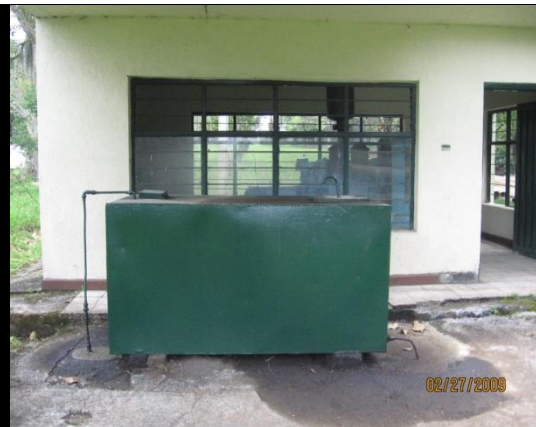
Figura 52. Tanque de combustible
