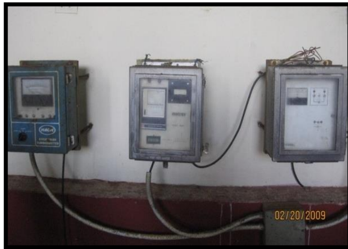
Figura 57. Medidores automáticos para el control dañados
