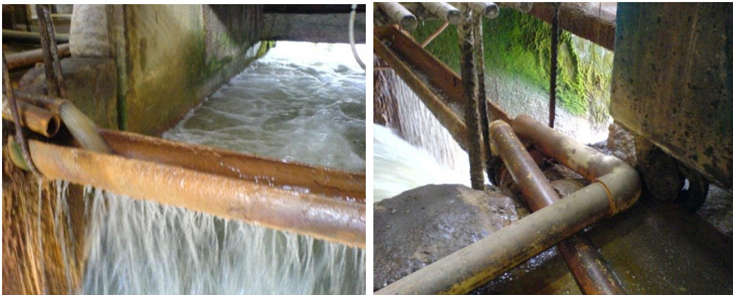
Figura 58. Corrosión en el punto de aplicación de coagulante
