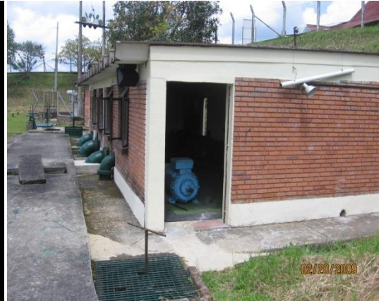
Figura 48. Estación de bombeo
