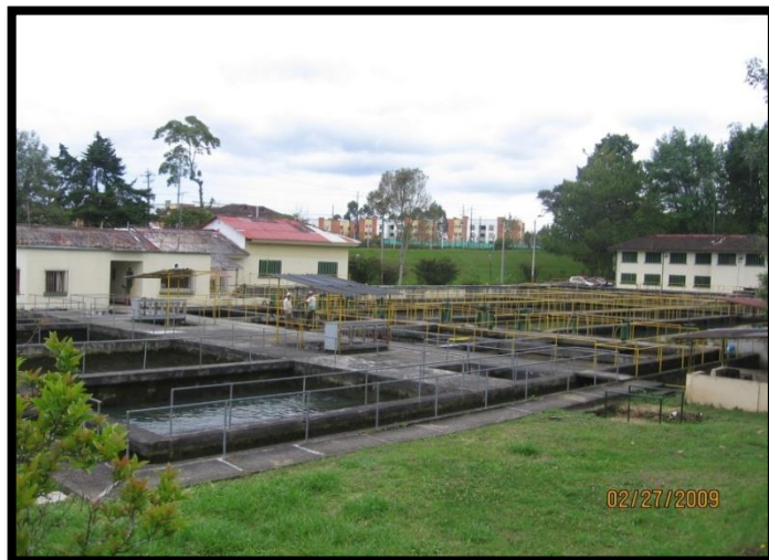
Figura 20. Planta de tratamiento “Tablazo”
