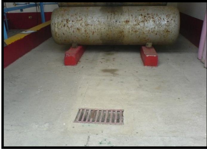
Figura 60. Drenaje de la caseta de cloración sin sellar
