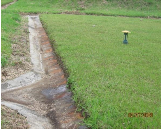
Figura 45. Drenaje del reservorio
