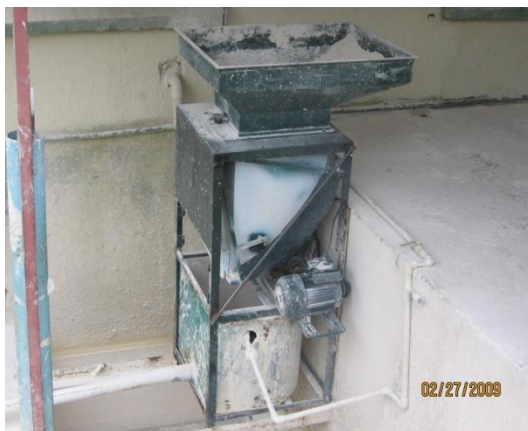
Figura 42. Dosificador de cal
