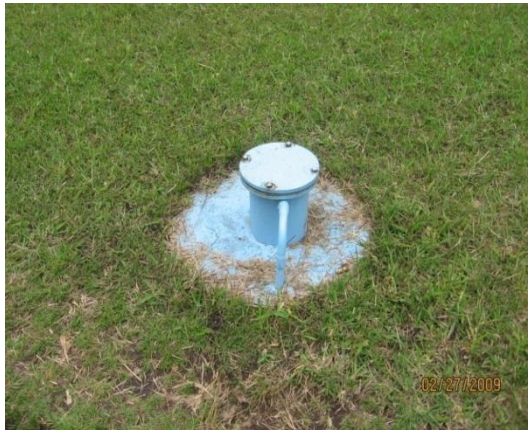
Figura 62. Medidor de nivel dañado
