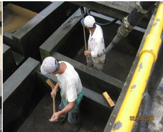
Figura 34. Mantenimiento de filtros
