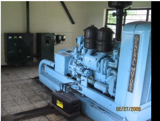
Figura 51. Unidad de energía auxiliar
