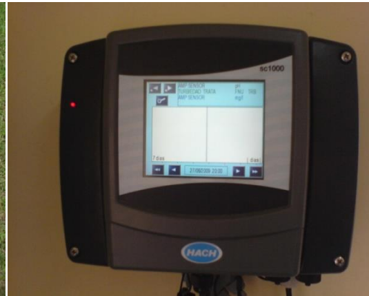
Figura 63. Analizador automático dañado
