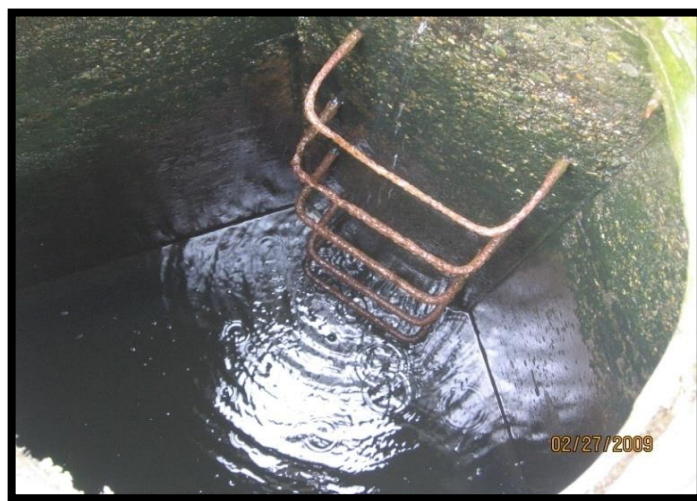
Figura 64. Corrosión en las escaleras de acceso a los tanques
