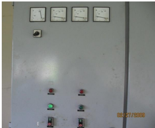
Figura 49. Sistema de control de bombas
