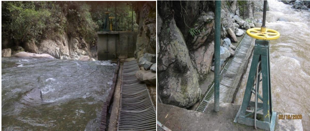
Figura 14. Captación río “Las Piedras”
