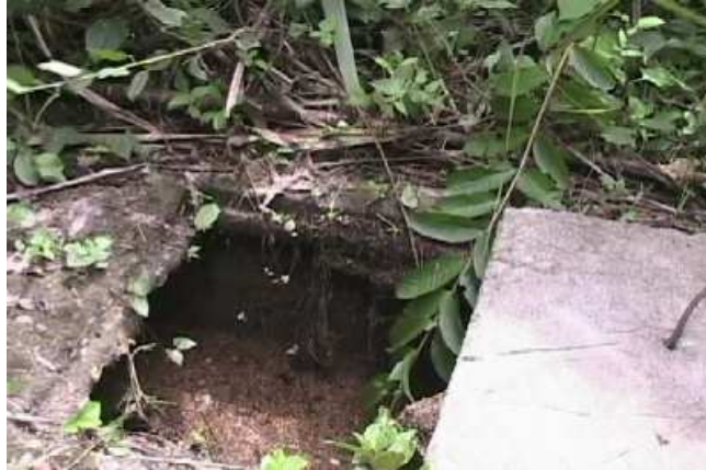
Figura 44. Tanque desarenador colmatado
