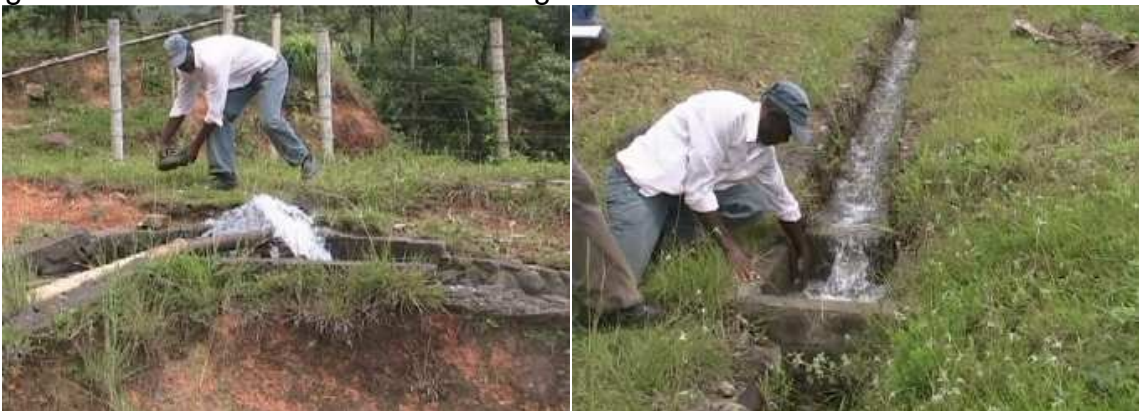
Figura 37. Sistema de distribución de agua
