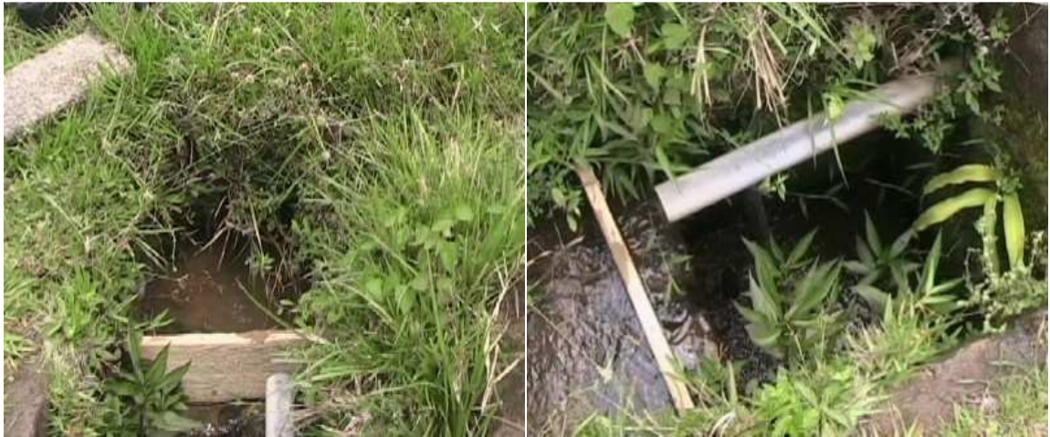
Figura 38. Caja de distribución controlada con madera
