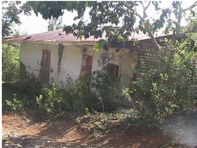
Figura 26. Vivienda abandonada del corregimiento Mindalá cerca a la estación piscícola, construida en bahareque, puertas y ventanas en madera, piso en tierra y techo en zinc
