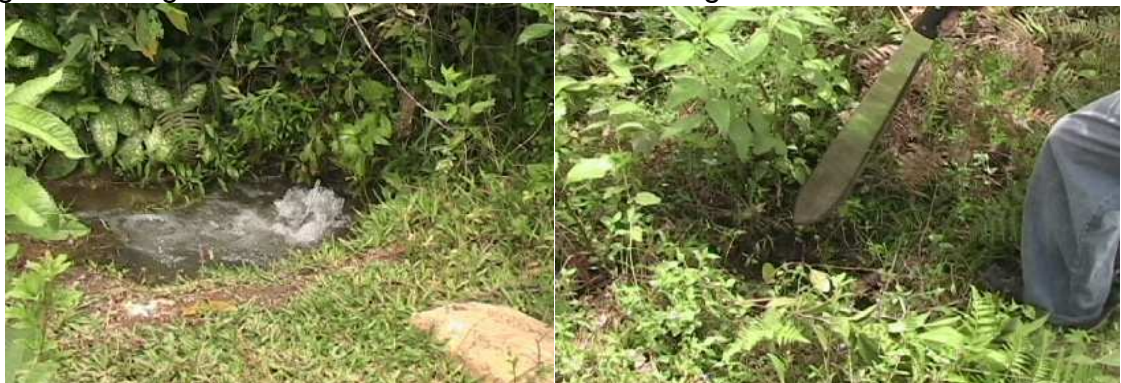
Figura 43. Fugas en el sistema de conducción del agua
