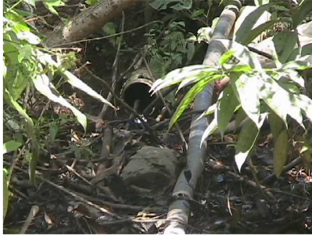
Figura 11. Vertimiento de aguas servidas proveniente de una vivienda
