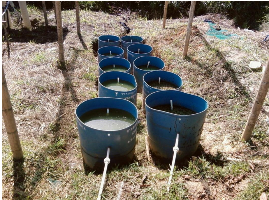
Foto 2. Sistema piloto de lagunas de estabilización
