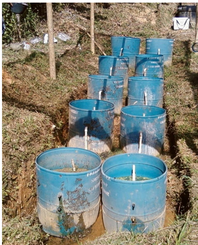
Foto 5. Vista frontal del Sistema de lagunas
