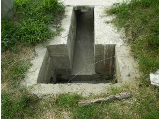
Fotografía 10. Caja de sedimentación.
