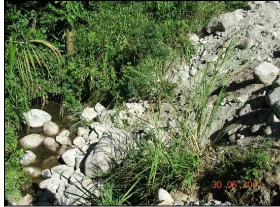
Material de corte en fuente hídrica PR63+930
