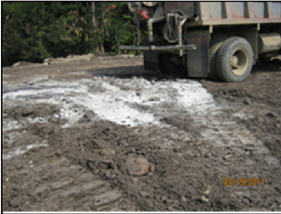
Evidencia de lavado de Mixers en áreas no autorizadas SDM del PR68+650
