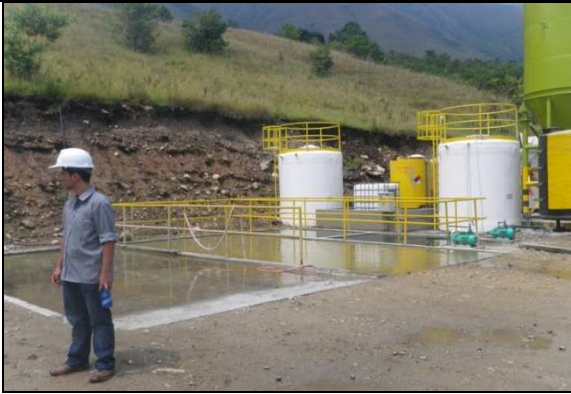
Rebosamiento en el Área del sedimentador del patio 3 por causa de la lluvia
