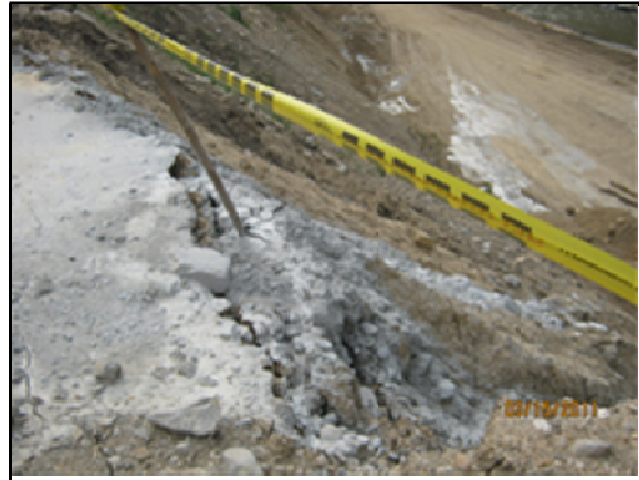
Evidencia de residuos de Mixers en el PR72+600 (talud de SDM); ver fotos de abajo
