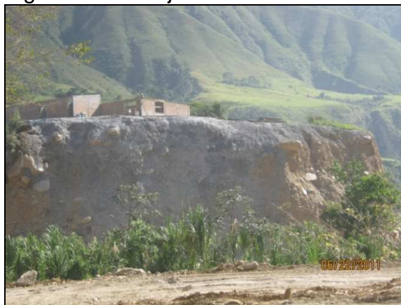
Manejo de Talud (impermeabilización) en La Planta de Trituración y Concreto Hidráulico PR73+180 Fuente: Elaboración propia.
