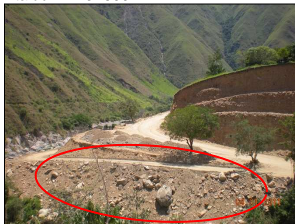
Figura 17. Erosión en talud PR73+800
