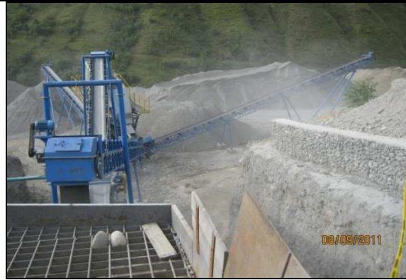
Emisiones atmosféricas de material particulado por fuentes fijas (trituradora)
