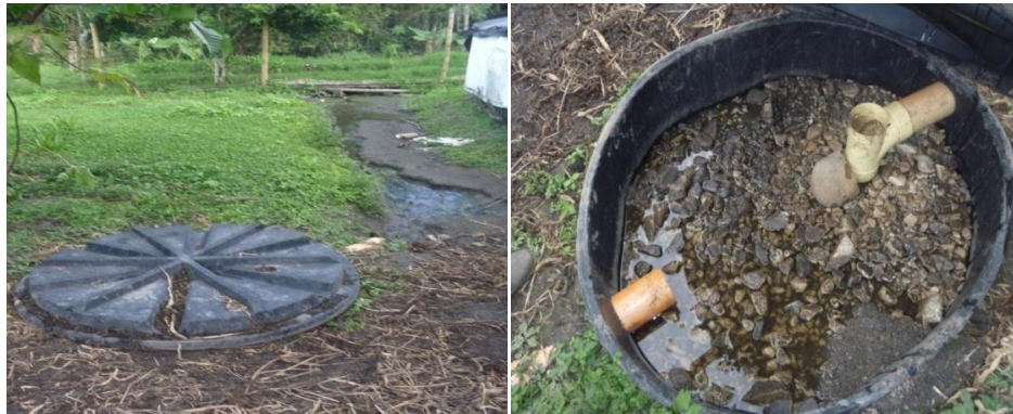
Figura 21. Segundo filtro, quinto tratamiento que reciben las aguas domésticas, tapado y destapado
