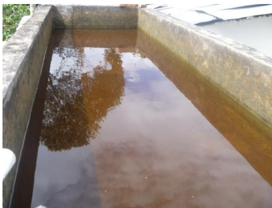
Figura 26. Tanque de almacenamiento de agua de la finca
