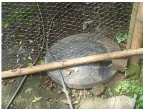
Figura 17. Segunda trampa de grasas, primer tratamiento que reciben las aguas domésticas (cocina)
