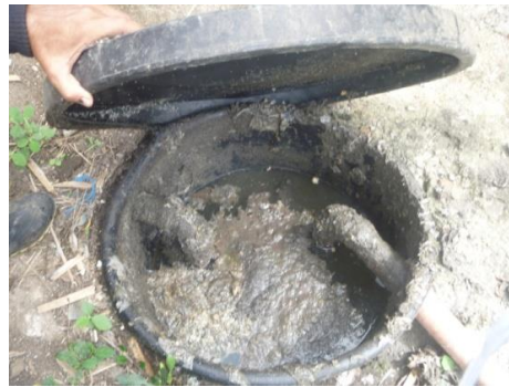
Figura 16. Primera trampa de grasas, primer tratamiento que reciben las aguas domésticas (ducha, lavamanos, lavadero)
