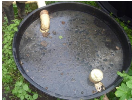
Figura 18. Primer filtro, segundo tratamiento que reciben las aguas domésticas vista frontal destapado
