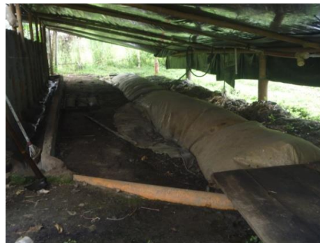
Figura 19. Biodigestor, a donde llegan las aguas domésticas para recibir su tercer tratamiento
