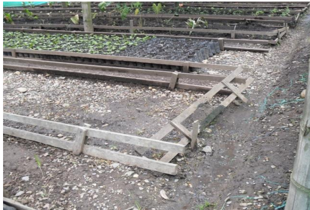
Figura 11. Deterioro de la cerca de las camas de germinación
