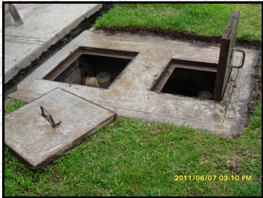
Fotografía 6: Trampa de grasas – Rancho de Tropa
