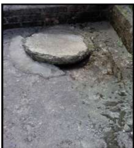
Figura 13. Cámara de quiebre en la vereda Paraíso
