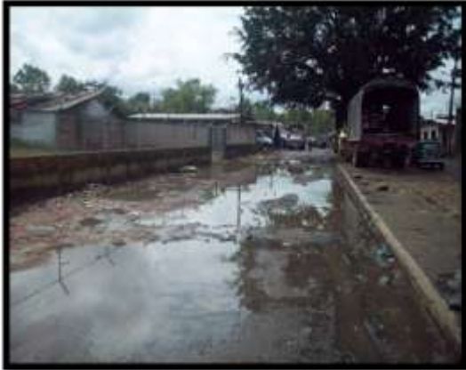
Colector y sumideros del barrio Bolívar obstruidos
