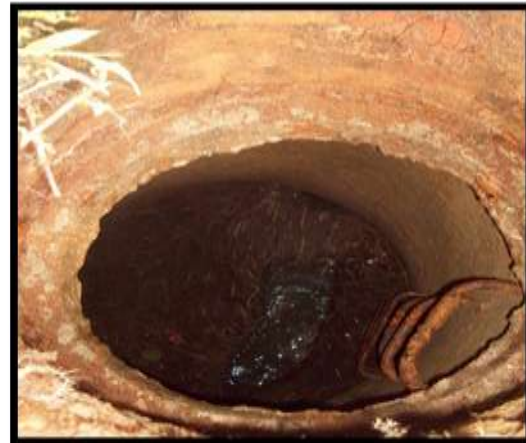
Barrio retiro bajo, la cámara esta obstruida por raíces y materiales arrastrados.
