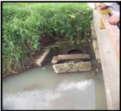
Barrio El Dean la estructura de aislamiento del colector se encuentra colapsada
