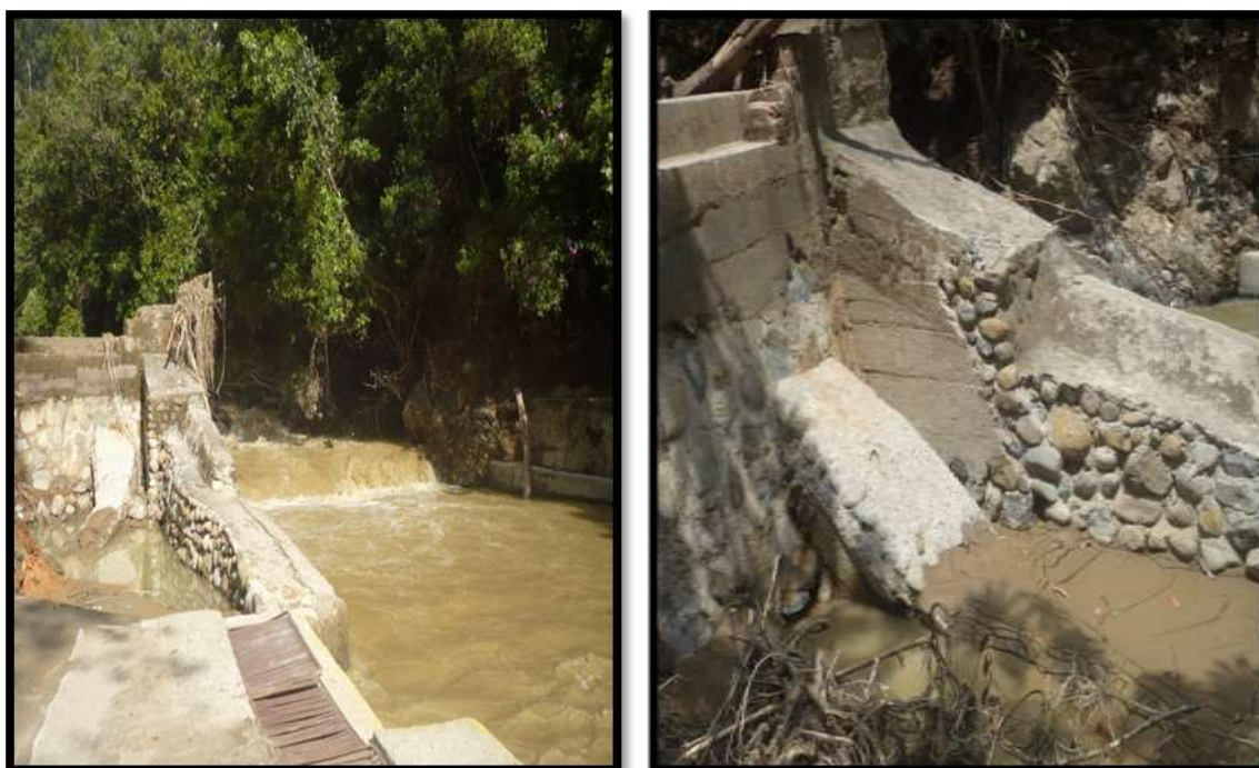
Figura 23. Estructura de la bocatoma afectada por la creciente del 7 de marzo de 2011
