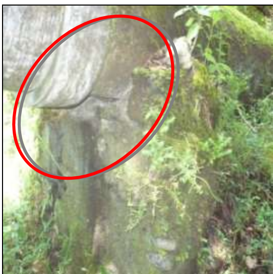
Figura 21. Estructura de soporte deteriorada sistema Tulcán
