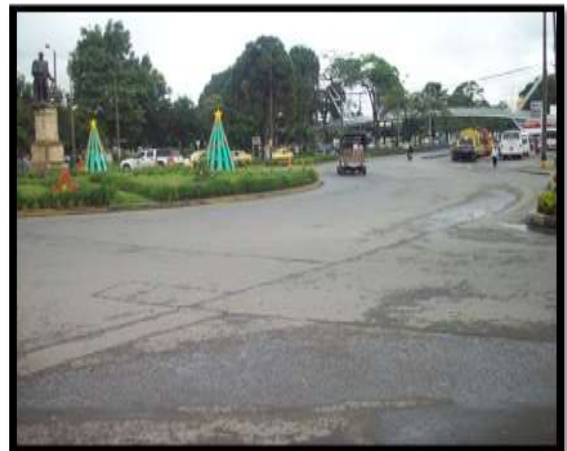
Avenida panamericana, frente al terminal de transportes, el colector tiene aprox. 30 años
